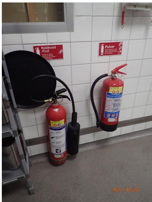
Bild 3. Handbrandsläckare i restaurangköket.
