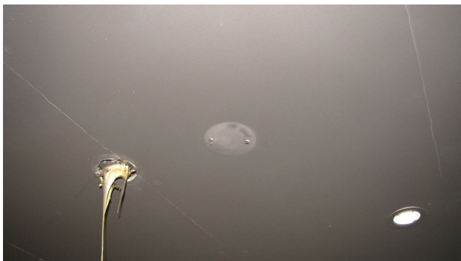
Figur 2. Taket i hallen på andra våningen där det tidigare troligen suttit en brandvarnare. Hela andra våningen sot- och rökskadades.
