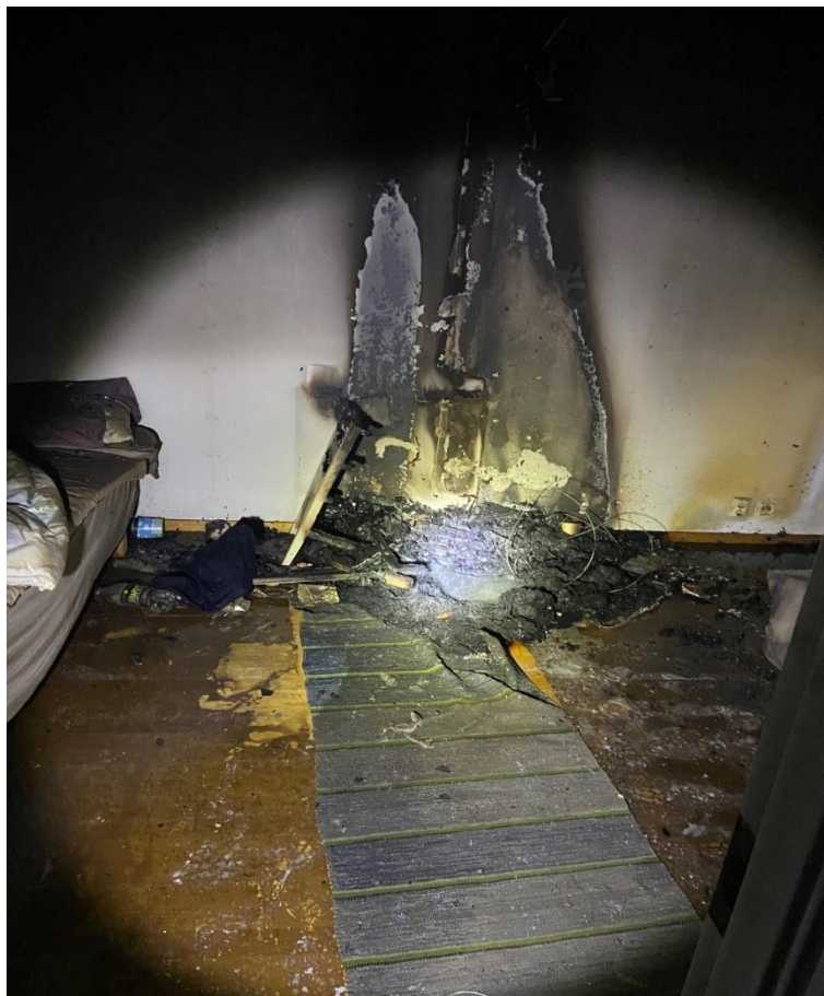
Figur 3 Brand- och sotskador på vägg samt rester av sängbordet
