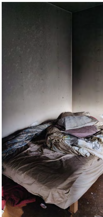
Figur 5 brand- och sotskador på vägg och tak
