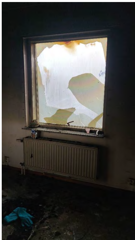
Figur 6 Sovrumsfönstret. Det innersta glaset har spruckit av värmen
