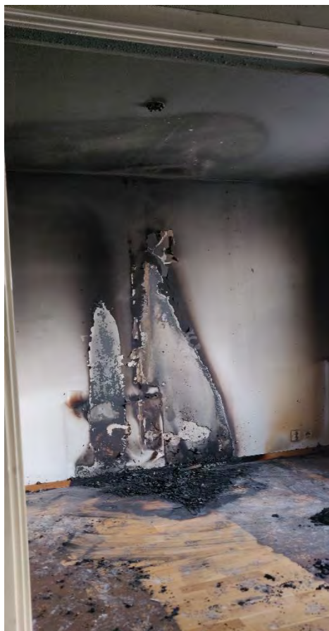
Figur 4 brand- och sotskador på vägg och tak
