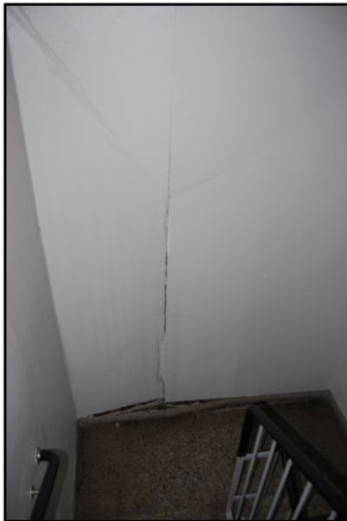
Figur 13 visar skadad vägg. Källa RSG
