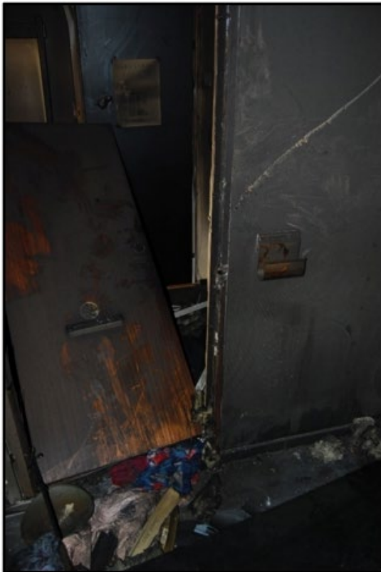
Figur 17 visar intryckt lägenhetsdörr i trapphus 22. Källa RSG
