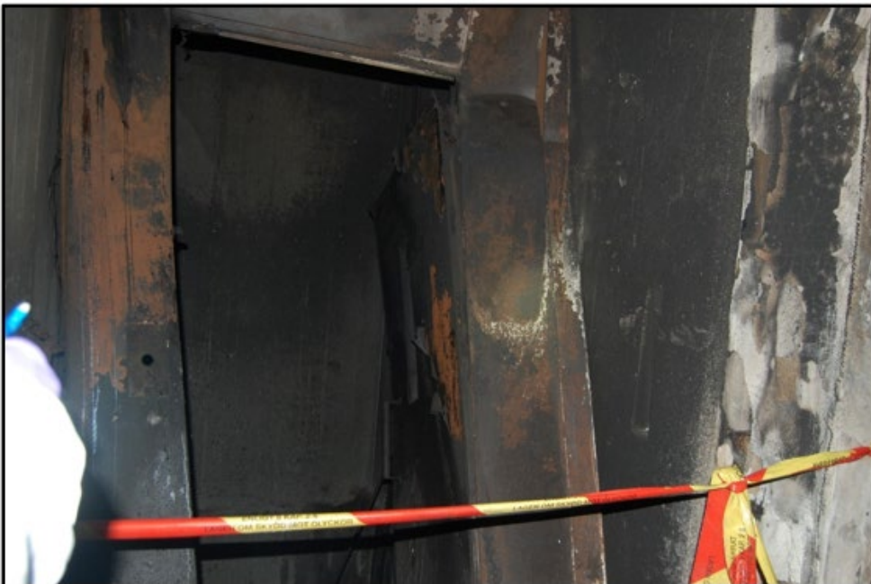
Figur 15 visar hissörr plan -2 som är intryckt i hisschaktet. Källa RSG
