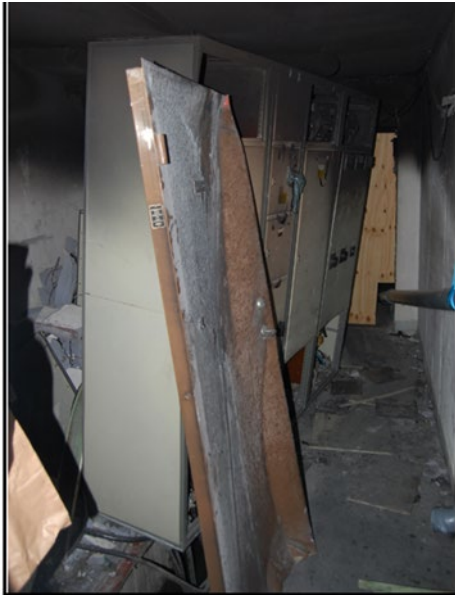
Figur 23 visar den elcentral som delvis blockerade ingången till källarutrymmet. På andra sidan den plywood-försedda öppningen finns parkeringsgaraget. Dörren på bilden har ställts dit efter branden. Källa RSG
