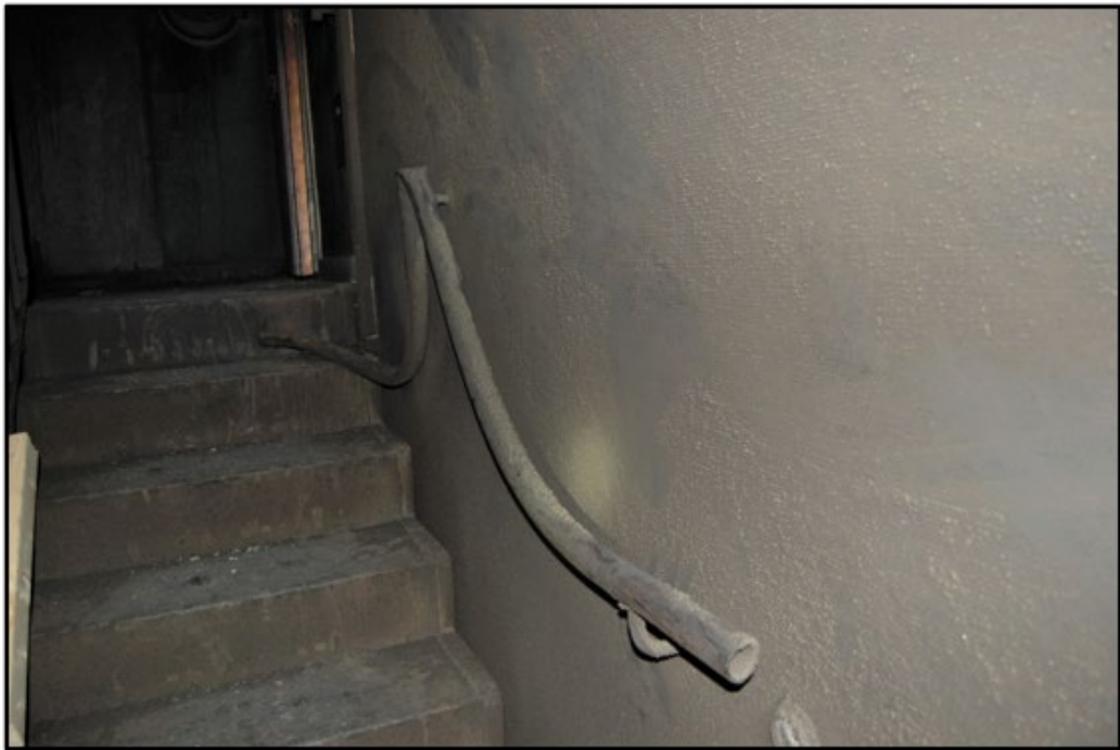
Figur 18 visar värmepåverkat trappträcke i trapphus 22. Källa RSG
