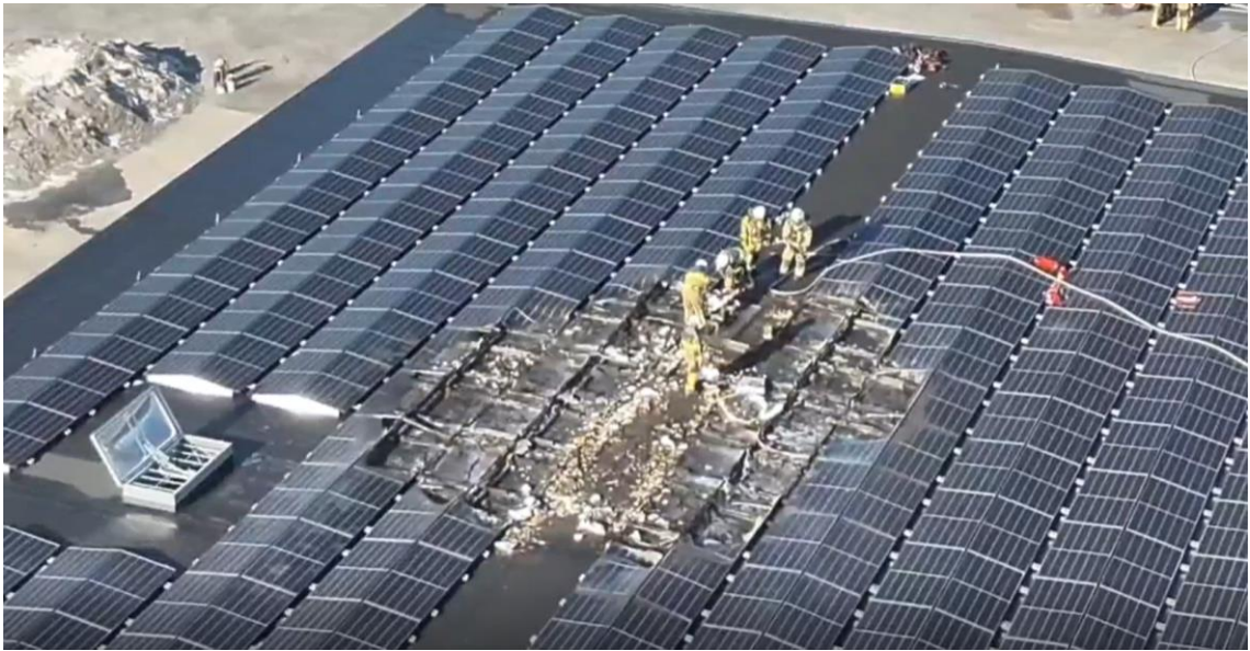
Figur 8. Bild tagen under eftersläckningsarbetet.
