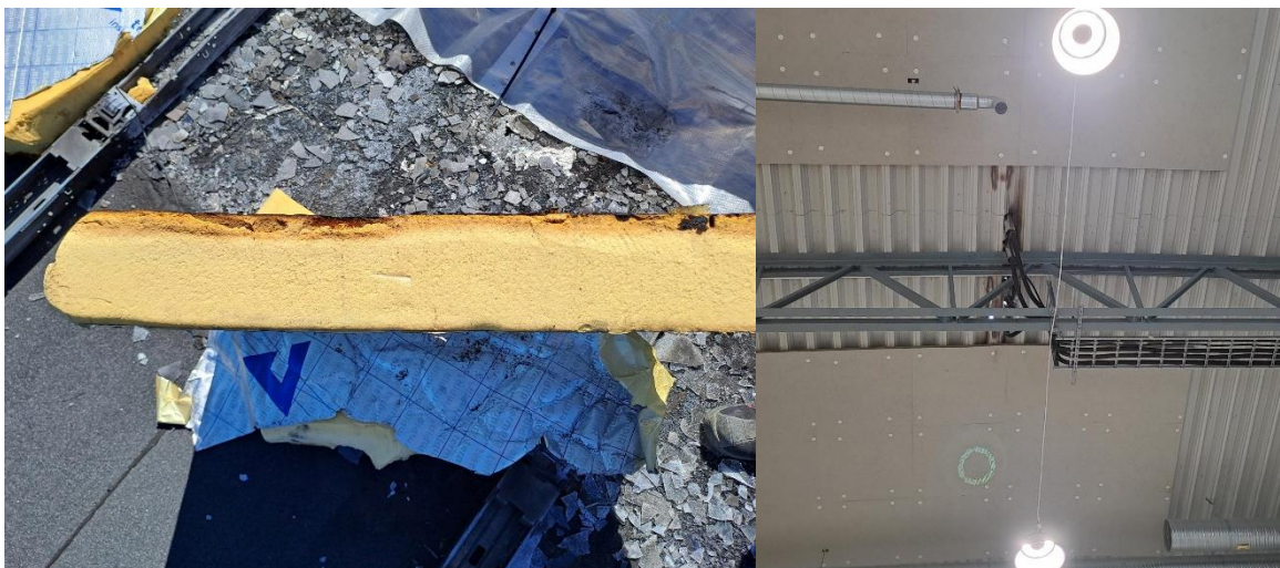
Figur 9. Vänster: Närbild på den brandskadade isoleringen. Höger: Hålet i taket inifrån lagret.
