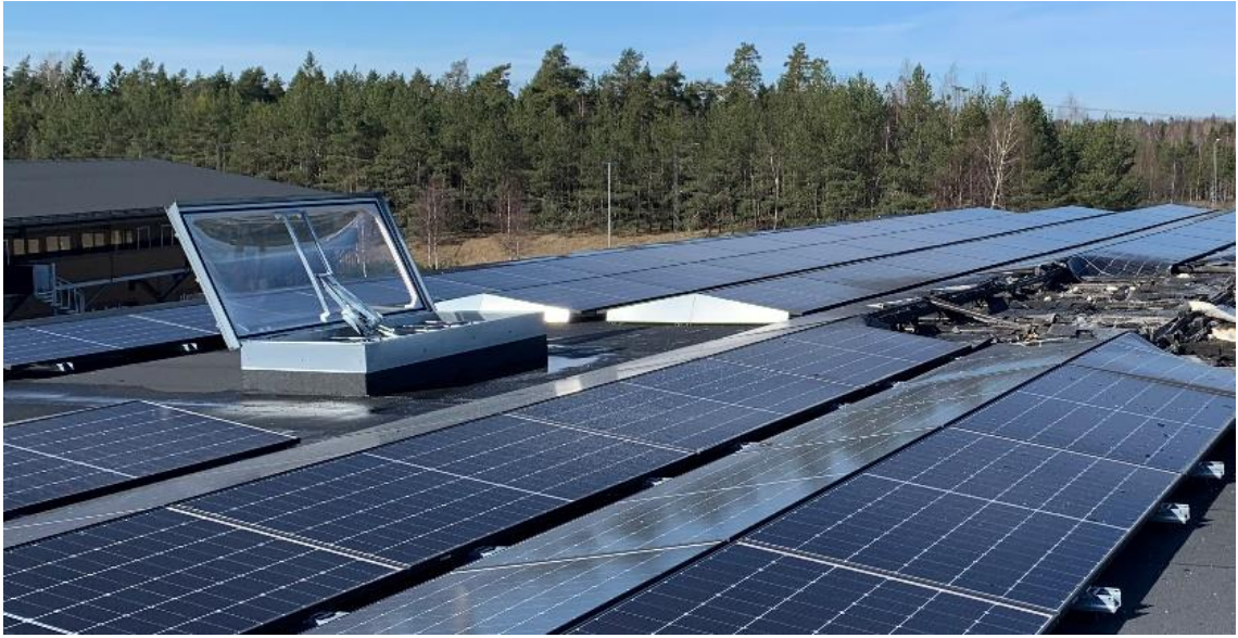
Figur 10. En av rökluckorna samt del av den avbrända ytan.
