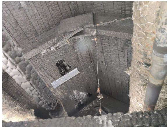
Figur 6. Upp mot taket ser man kraftiga brandskador på trämaterialiet.
