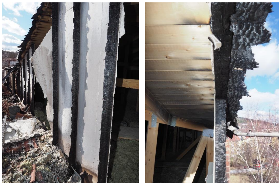
Visar resterna av gipsväggen. Ena sidan bortbränd men insidan fortfarande till stor del kvar. Bilden till höger visar tydligt vilket nytta väggen gjort
