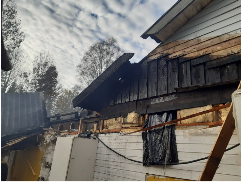
Brandskadad vägg på grannhuset
