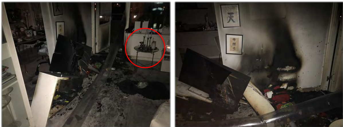
Figur 7, 8, Tv-bänken oskadad i den vänstra delen, sotbilderna på väggen i figur 8.
