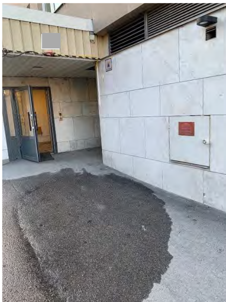
Visar luckan i fasaden märkt "Brandpost". Ingen skylt som talade om att även stigarledningen trycksätts härifrån.
