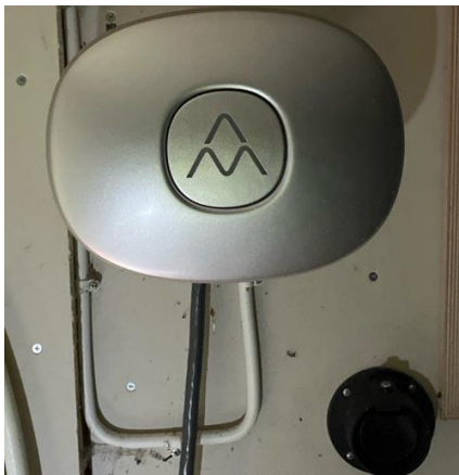
Bild 4. Laddstation placerad i garaget
