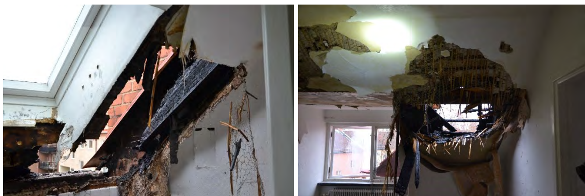
Figur 8. Synliga brandskador i takkupor sett inifrån lägenhet på Eskilsgatan 9.
