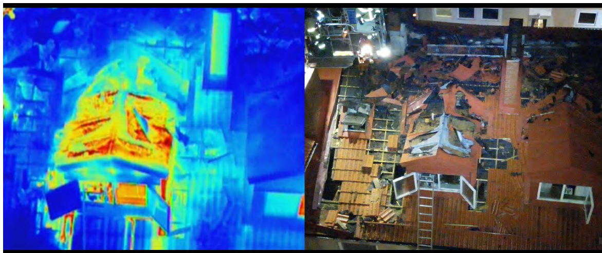
Figur 7. Bild från drönare över värmespridning och skador på takkupa mot innergården.
