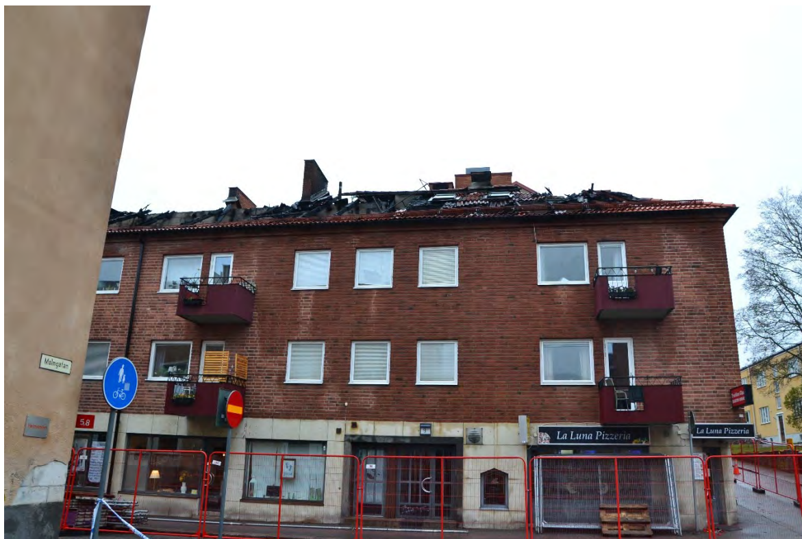
Figur 9. Mörka partier av väggen visar på fukt i fasaden. Bilden är tagen 10 november, två dagar efter branden.
