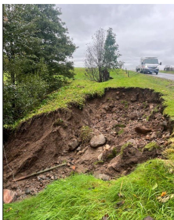
Bild 3 Vägsläntras väg 709 Bild: Trafikverket väst.
