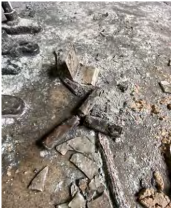
Figur 14 – Brandskadade och deformerade battericeller i annan del av rummet.
