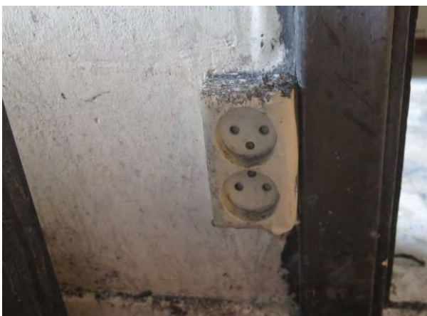
Figur 25 – Eluttag från vilket laddning av elcykelbatteri ska ha skett. Kontakt hade enligt uppgift dragits ut innan dess att smällen skedde.
