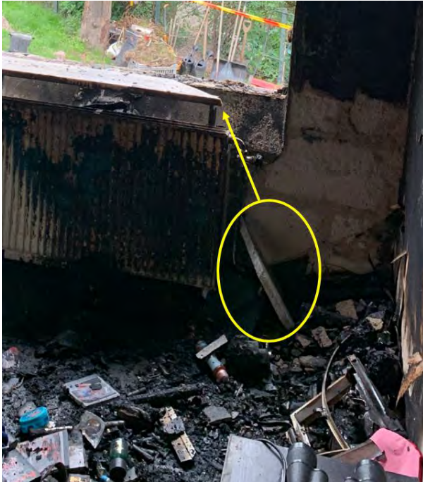
Figur 18 – Friliggande fönsterbänk av marmor har gått av. Foto polisen.
