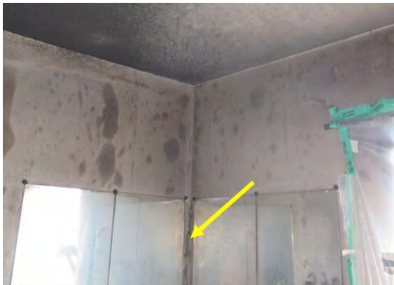
Figur 29 – Sprickbildning mellan yttervägg långsida och yttervägg gavel.
