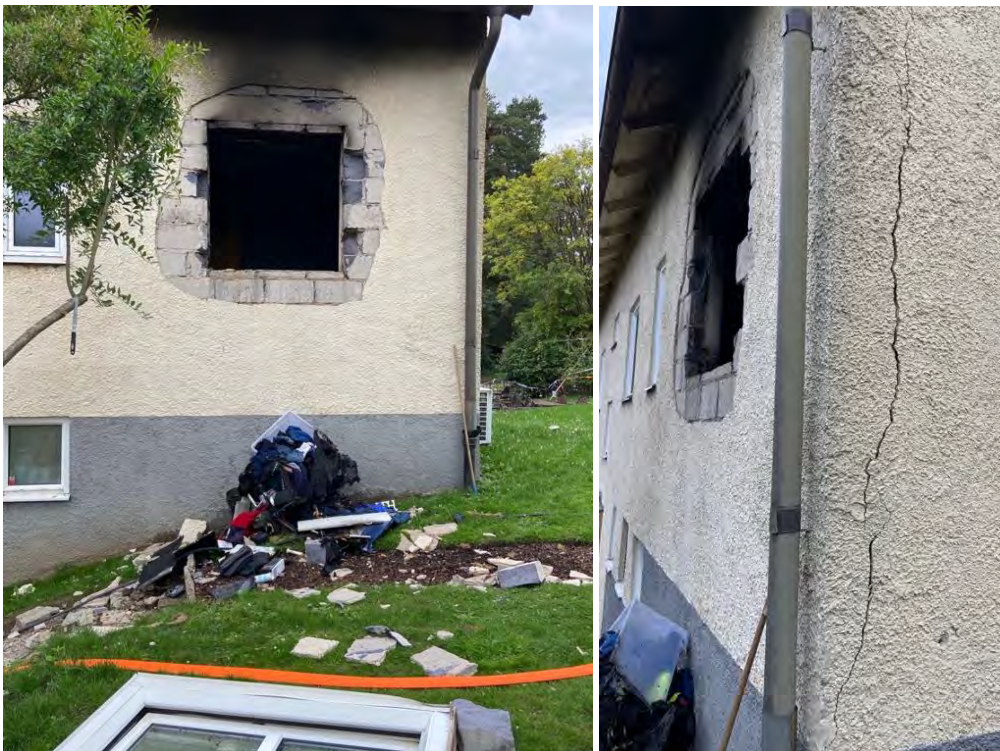
Figur 11 – Översikt utvändigt efter lämpning (t.v.). Närbild sprickbildning i fasad på gavelsida (t.h.).
