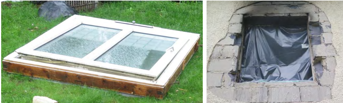
Figur 20 – Överstycke av fönsterkarm närmast i bild. Insidan av fönstret uppåt (låg nedåt efter händelsen). Till höger visas fönsteröppningen och skadorna på fasaden runt denna öppning.
