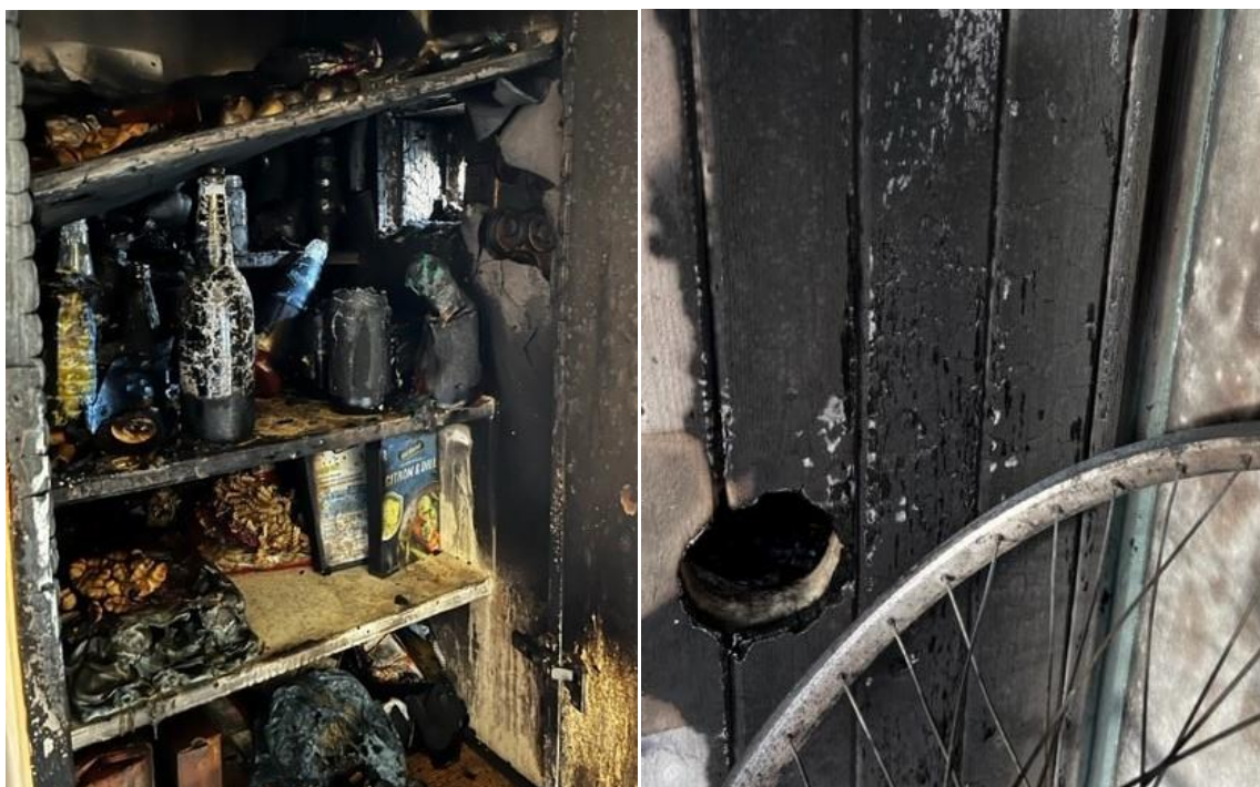
Figur 2. Ventilationsöppning i skafferi och utlopp på balkongen.
