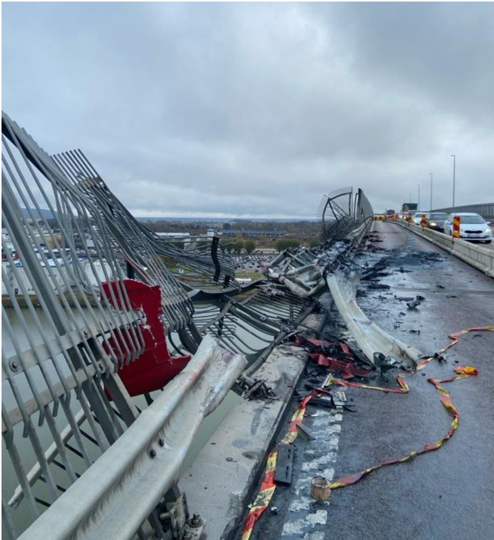
Figur 4: Skador på räcke och vägbanan. Foto räddningstjänsten
