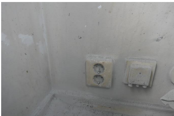
Figur 9 vägguttag bakom elmoped (på vägg mot köket)
