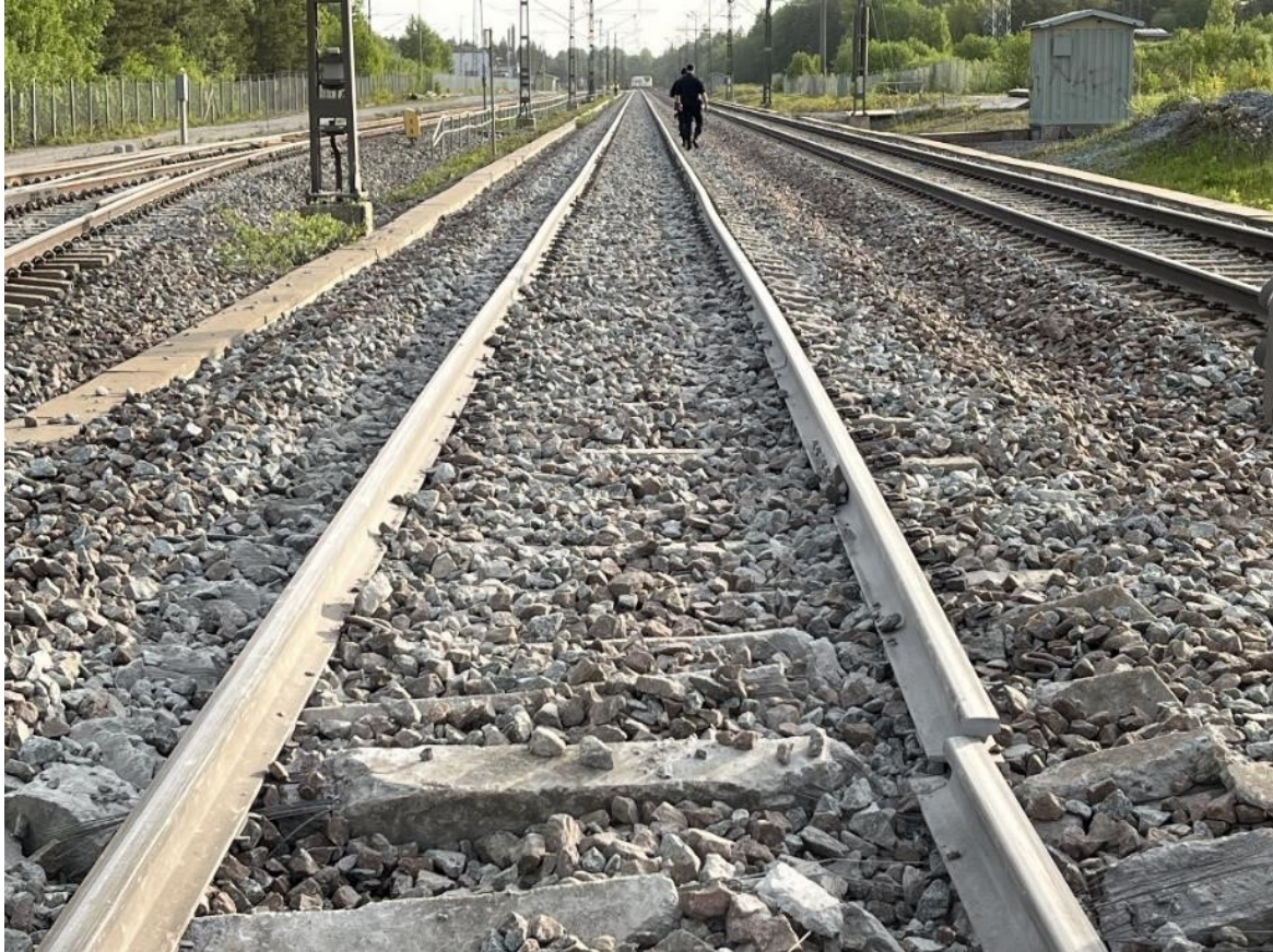
Figur 16 Spåret krossades efter tåget passerat under urspårningen. Notera skillnaden mellan det högra/södergående spåret.
