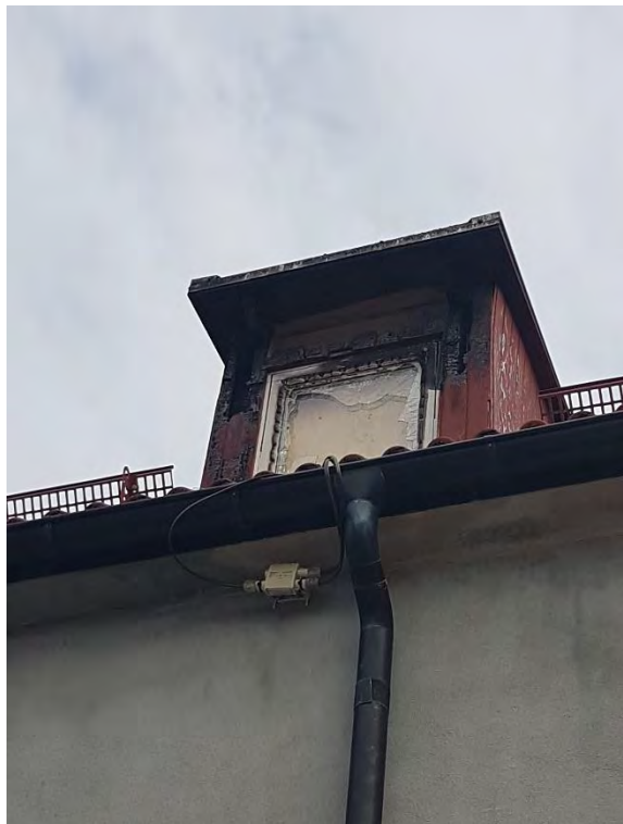
Figur 7 Förkolnad träpanel i anslutning till spräckt fönster
