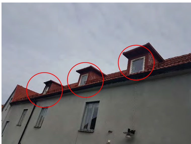
Figur 6 Spräckta fönster (Storgatan 14)
