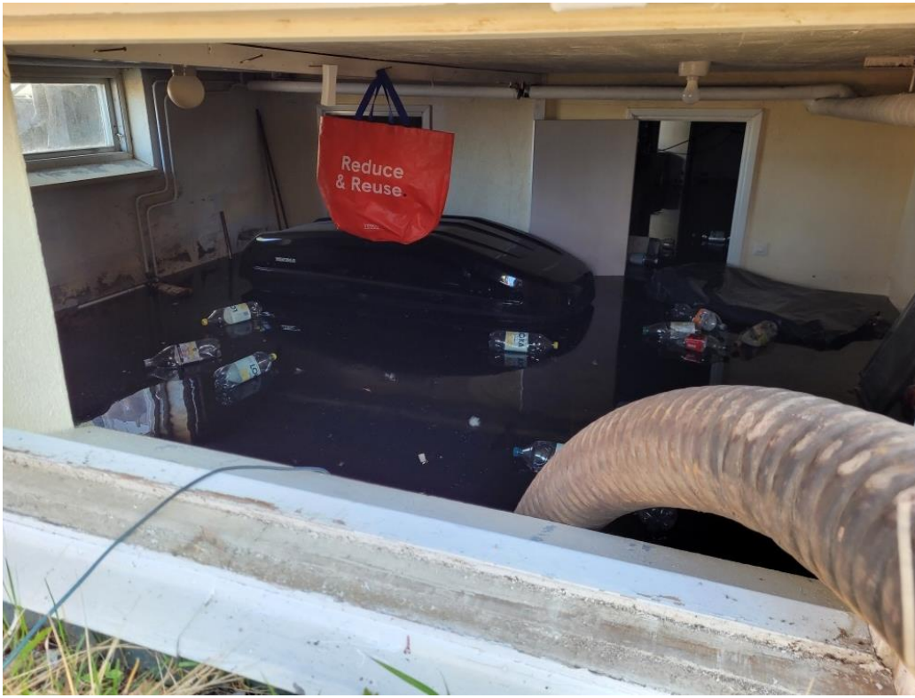
Bild 3. Översvämmad källare i en privatfastighet i Pajala. Fotografi: Räddningstjänsten Pajala.
