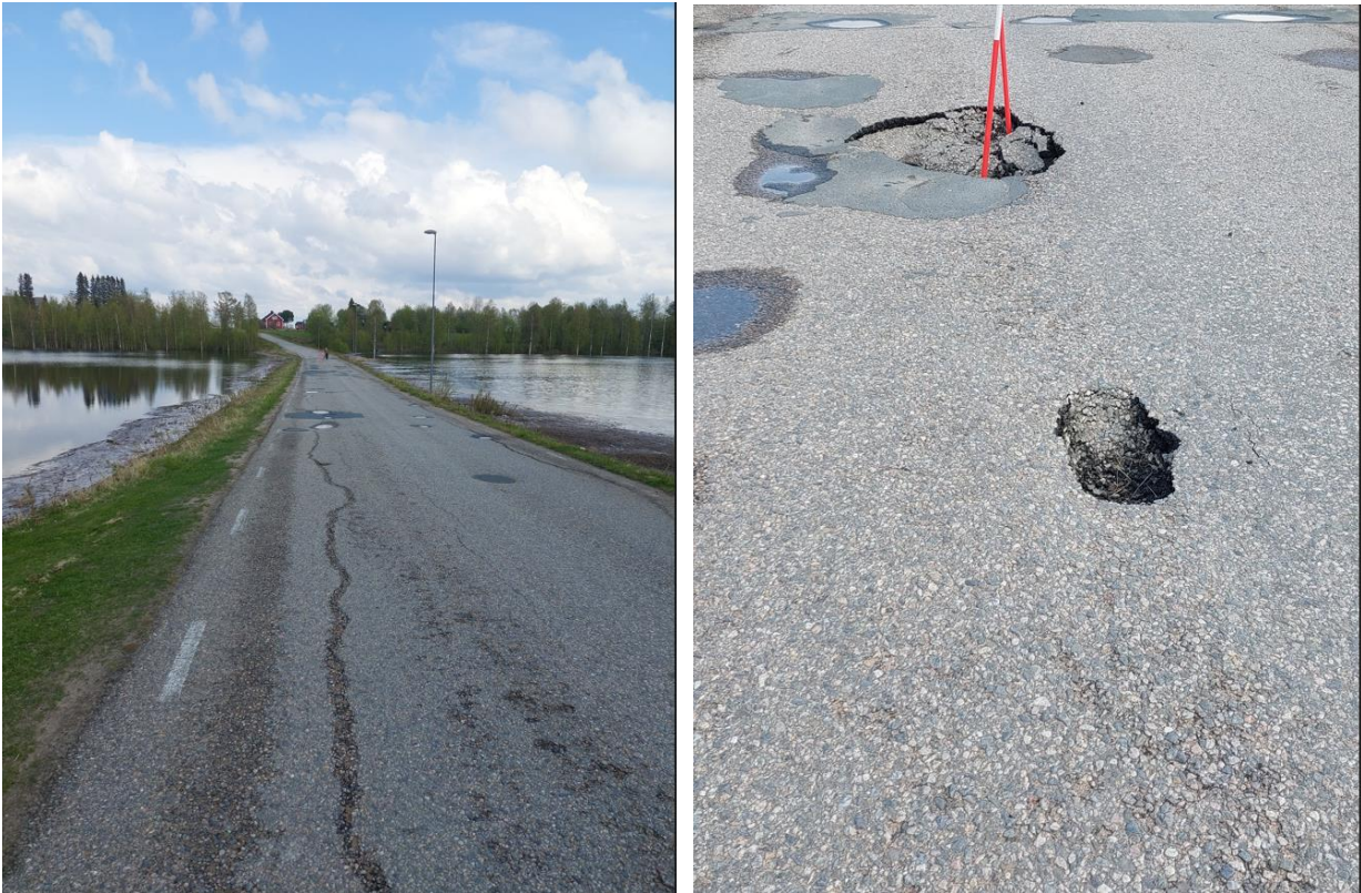
Bild 7. Väg 737 i Karungi samt skador på vägen efter att vattnet runnit undan. Bild: Trafikverket.
