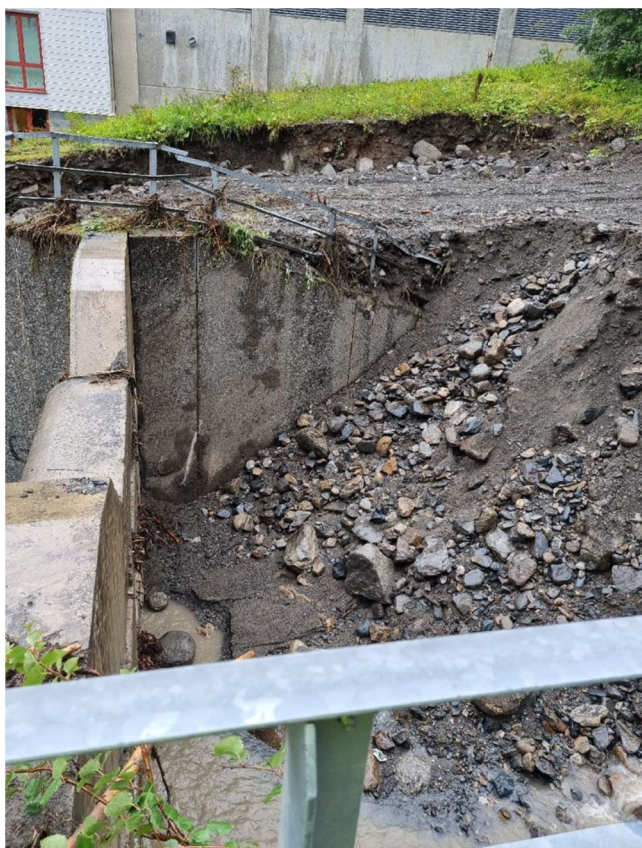
Slamficka Syd tömd på slam och erosions-skadan återfylld. Foto taget den 15 augusti. Foto: Sweco Calle Modin
