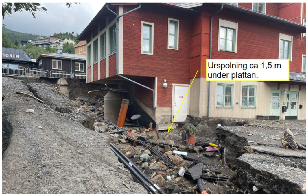
Sydvästra hörnet på Åre Prästbord 1:34 har urspolning ca 1,5*1,5 m under grundläggningen. Upp till 2–3 decimeter material är bortspolat. Foto: Sweco Calle Modin
