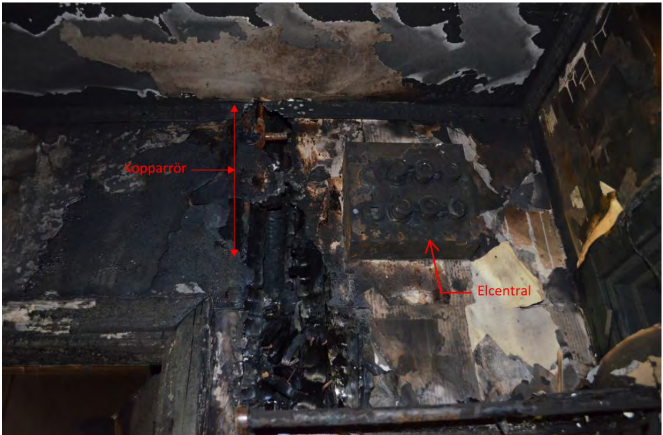
Figur 4:brandpåverkad elcentral och kopparrör
