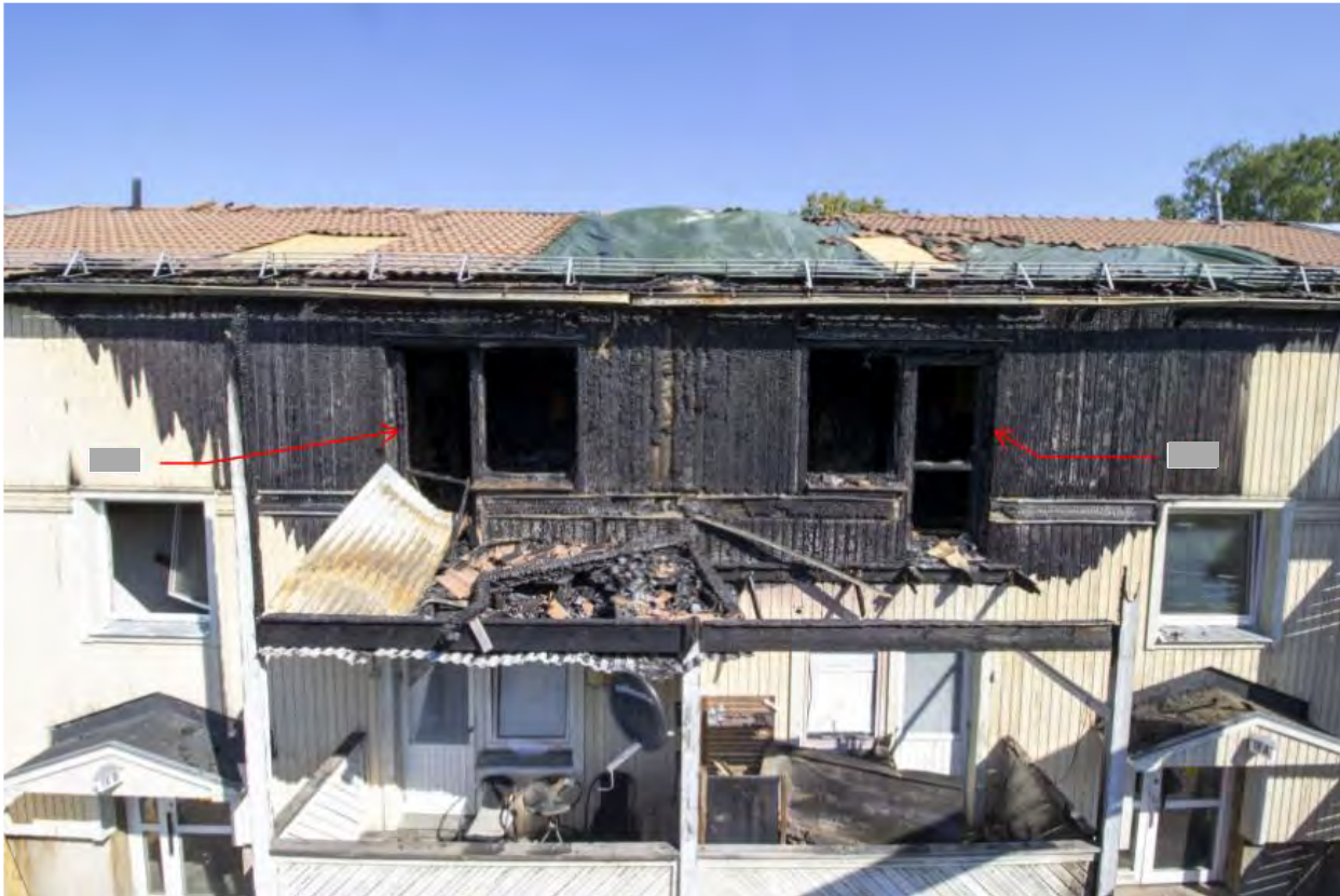
Figur 3: brandutsatta balkonger, bild från polisens brandplatsundersökning
