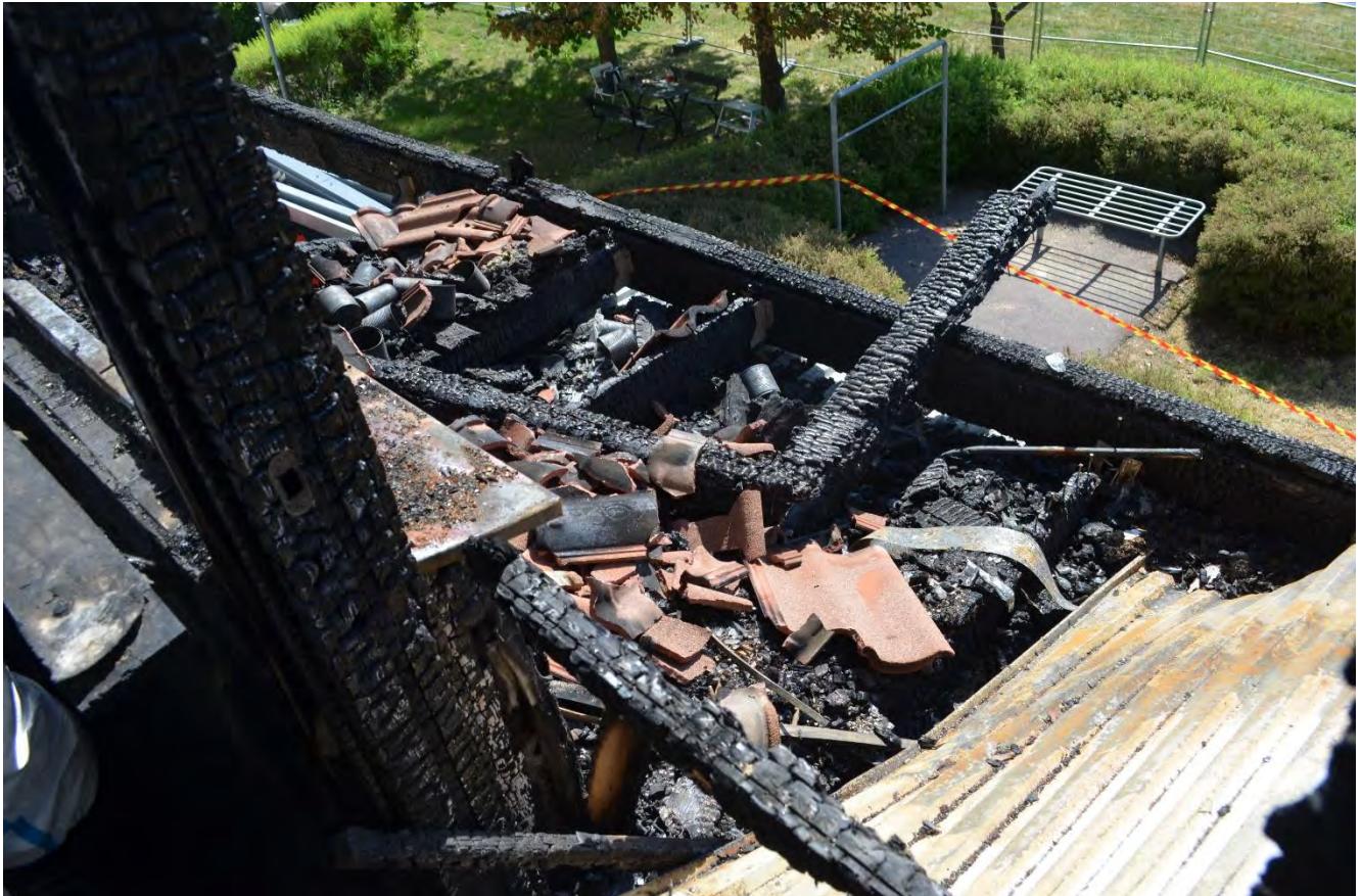
Figur 5: brandutsatt balkong sedd från lägenheten
