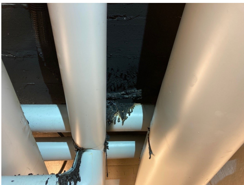
Figur 1 Brandutsatt kablage bakom rörstråk
