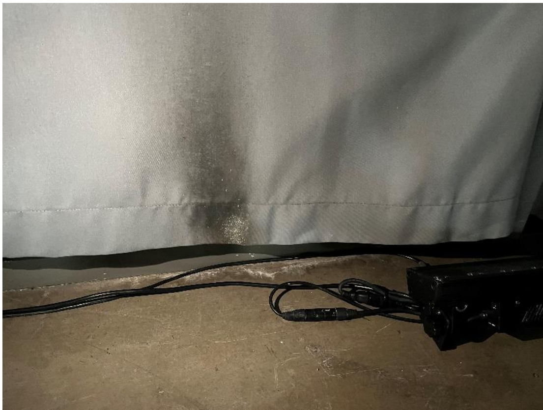
Figur 8. På bilden syns märken från värmepåverkan på den flamskyddade gardinen. Bild tagen av utredarna 2023-09-25.
