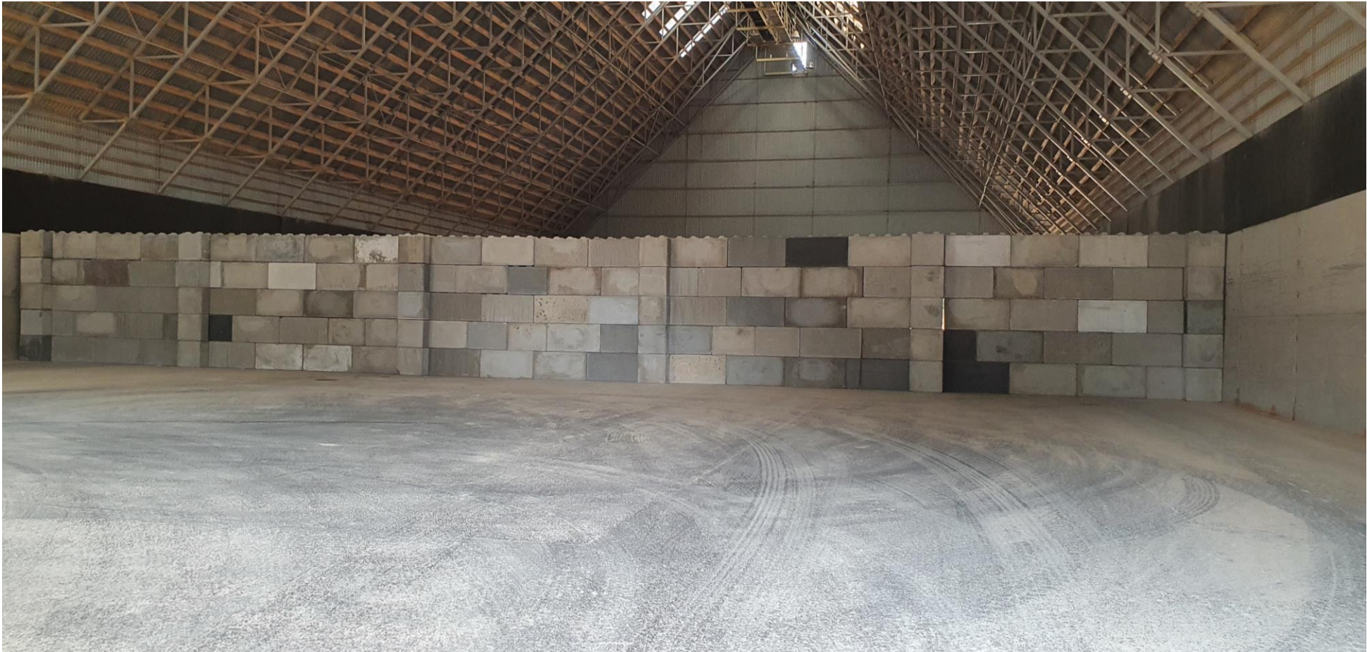
2022-11-17 Bild inifrån pelletsförrådet
