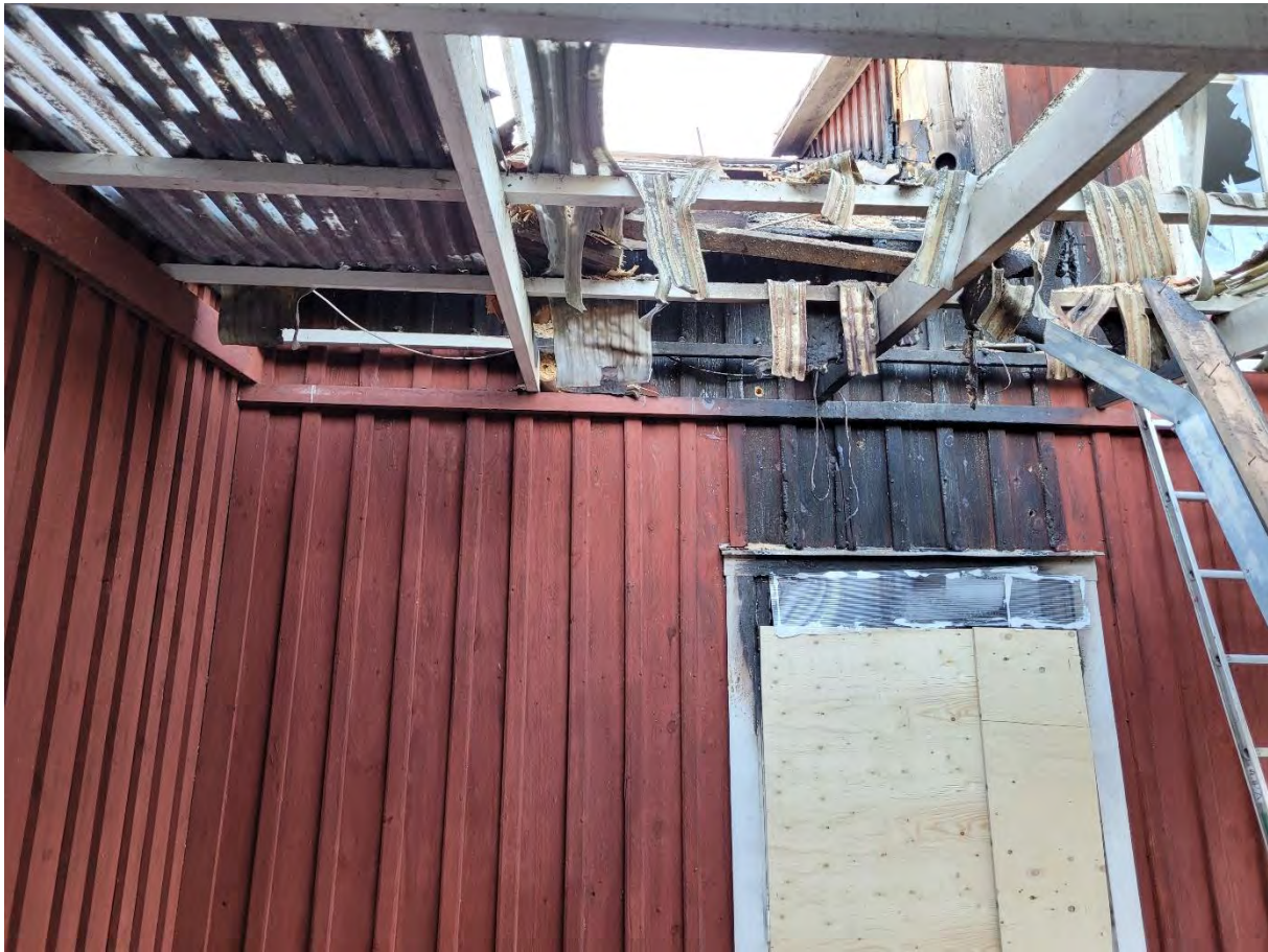
Figur 4. Bild på brandskador ovanför fönstret vid altanen.
