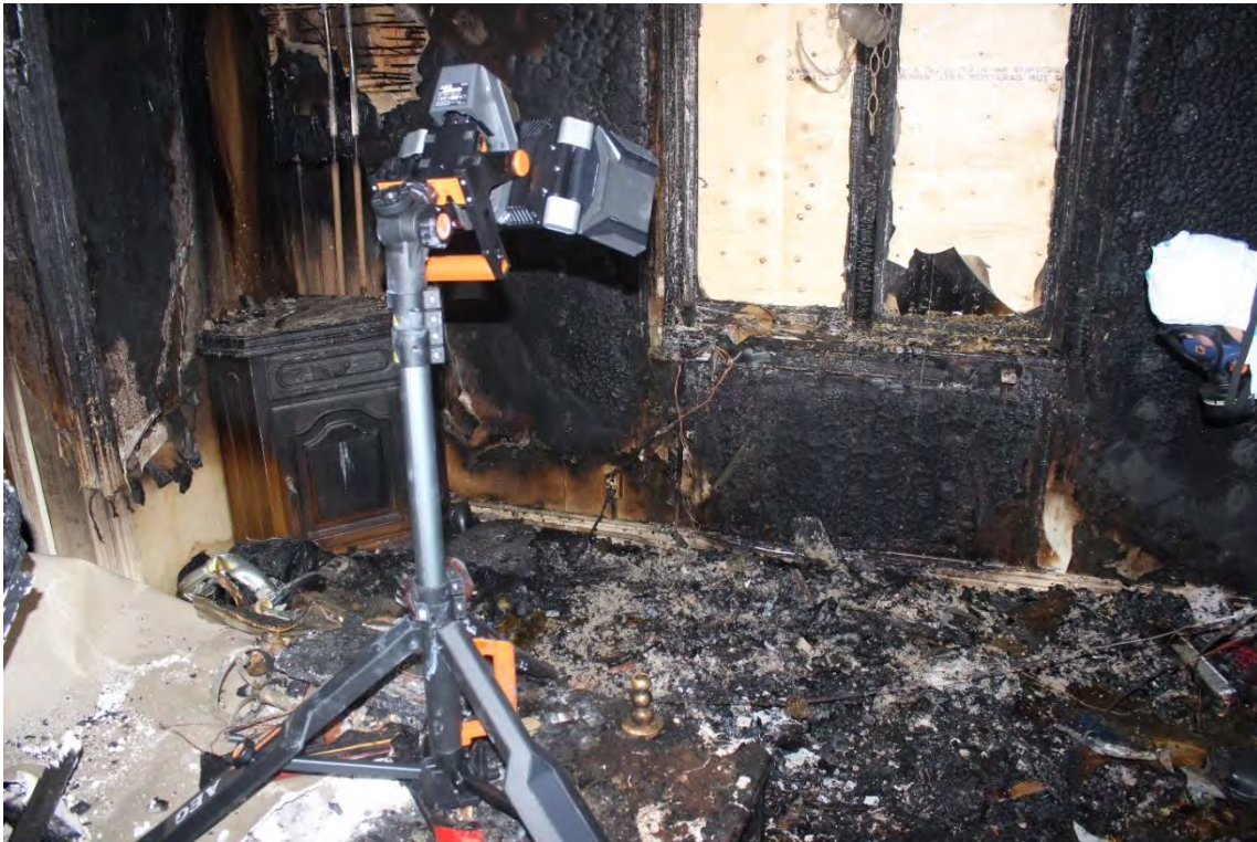
Figur 6. Bild på brandrummet och fönster mot altanen under platsundersökningen. Den syns tydliga brandmönster upp på väggarna med utgångspunkt från bäddsoffan.
