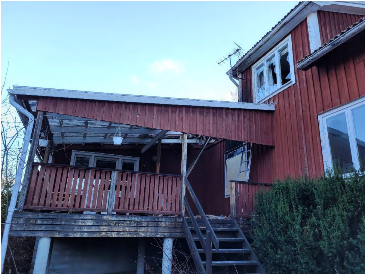
Figur 3. Bild på husets baksida med altan. Tydliga brandskador ovanför fönster till höger uppe på altanen (igensatt med plywood-skiva) samt mot takkonstruktion ovanför. Lågor har slagit ut från detta fönster och brandspridning har skett i takkonstruktionen.
