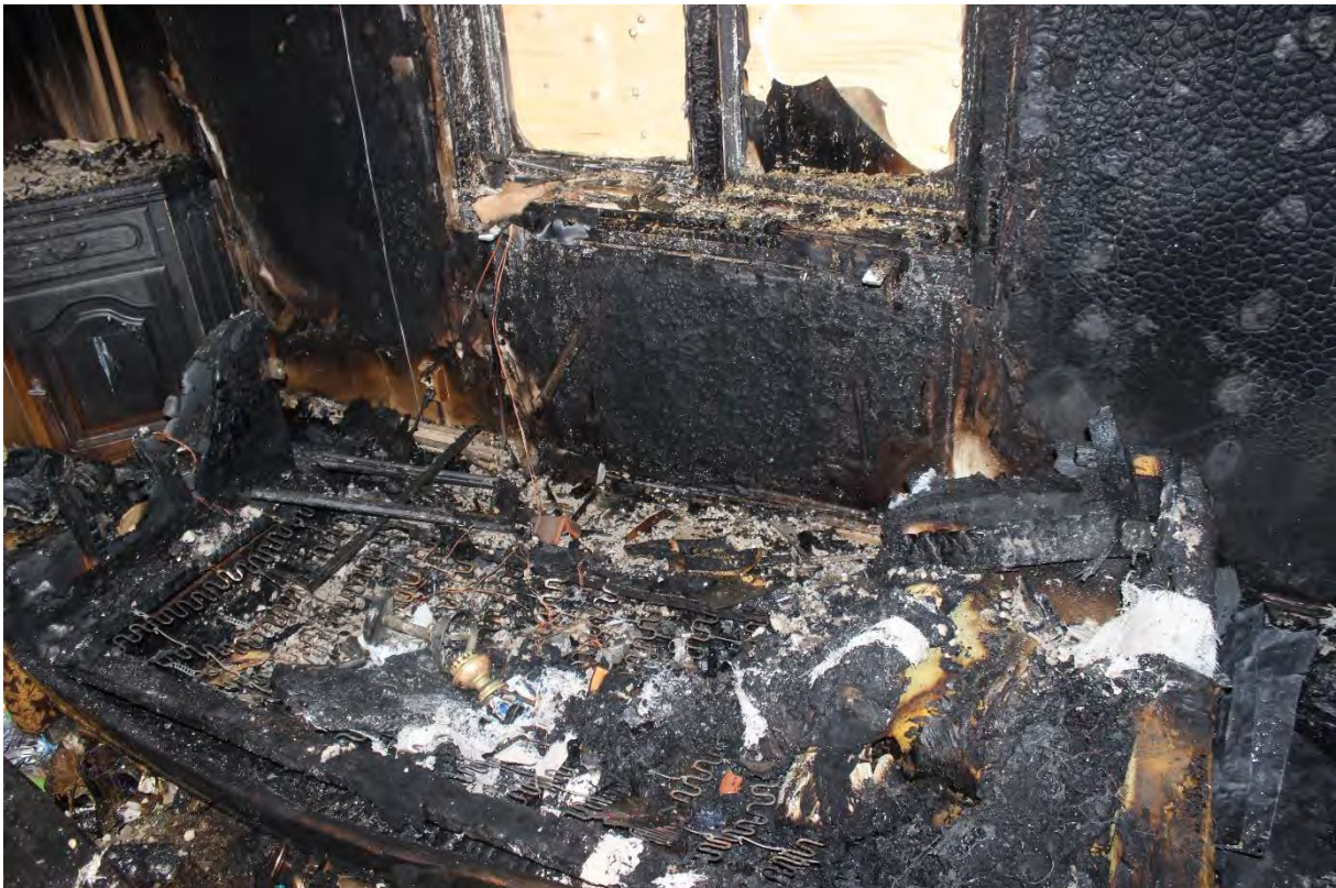
Figur 7. Bild på brandresterna från bäddsoffan.
