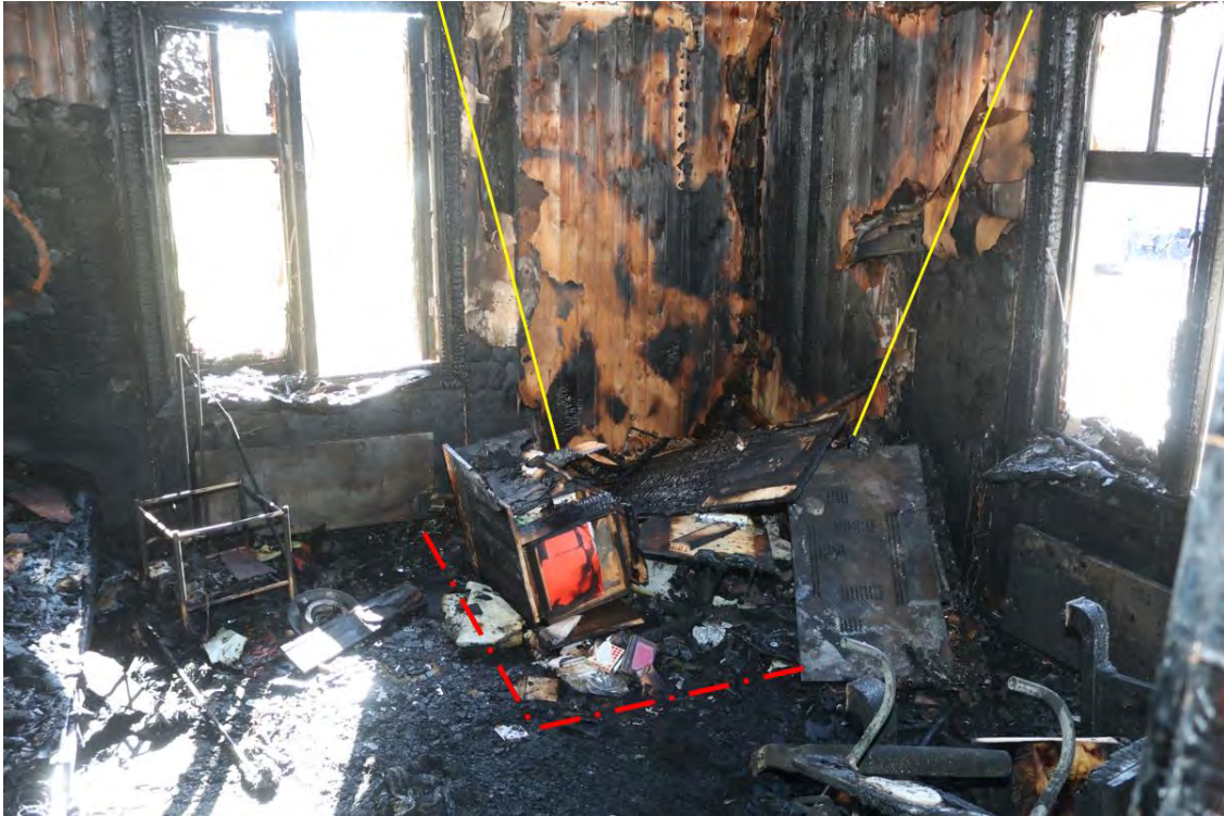
Figur 7 - Kraftig brandhård i sovrum. Indikeras bland annat av mer omfattande påverkan på väggmaterial (se gulmarkering). Bedömt primärbrandområde inom röd streckad linje. Foto från polisen med tillagda markeringar.
