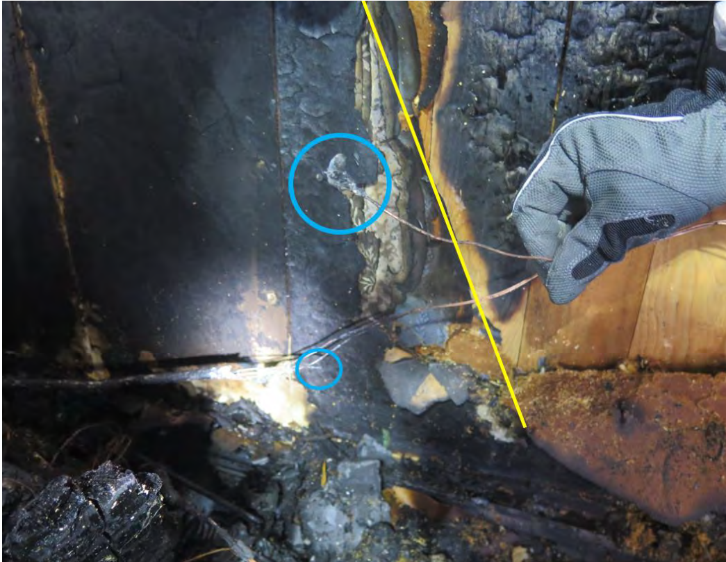
Figur 14 – Smältpärla/skada på ledare till element. Kabel återfinns bakom skrivbordet (utmed gavelsida) och bedöms ha löpt ovan golvsöcket.
