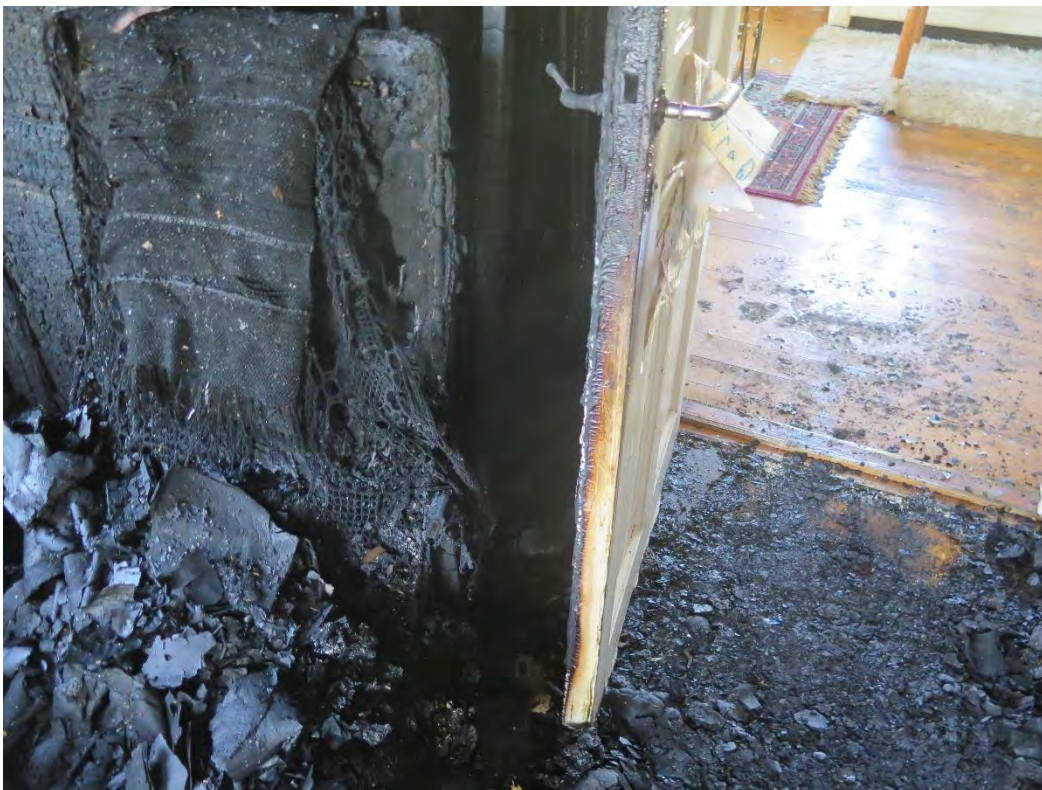
Figur 6 - Dörr mellan sovrum och vardagsrum har varit stängd under brandförloppet..
