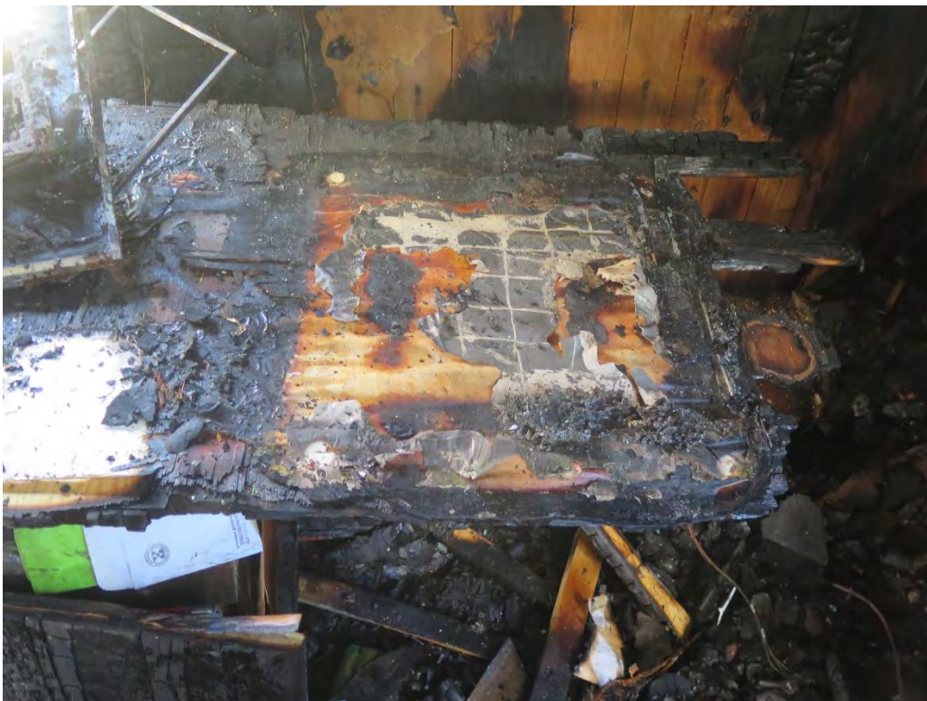
Figur 10 - Ovansida skrivbord. Notera tilltagande skada i riktning mot hörnet och skyddad yta där förstöringsapparat varit placerad. Skrivbordsskiva har ursprungligen varit avrundad in mot hörnet.
