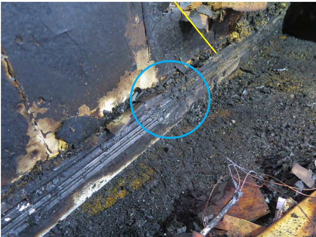
Figur 15 - Golvsöcket frilagd och skrivbordet flyttat. Materialet uppvisar avvikande och djupare tecken på skada i område där bedömd kortslutningsskada på ledare till element uppkommit (se figur 14). Skada kan dock vara sekundär.
