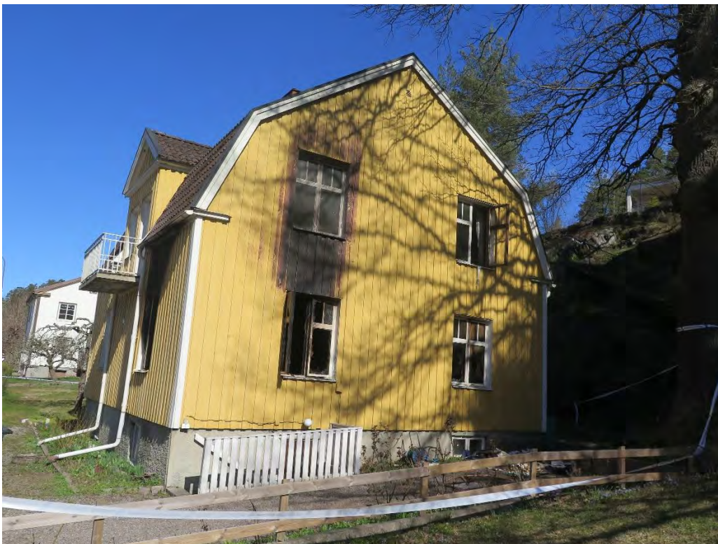
Figur 2 - Utvändigt foto från platsundersökning 2020-04-15. Foto mot sydöstra gaveln. Fasad är brandskadad ovanför respektive sovrumsfönster.
