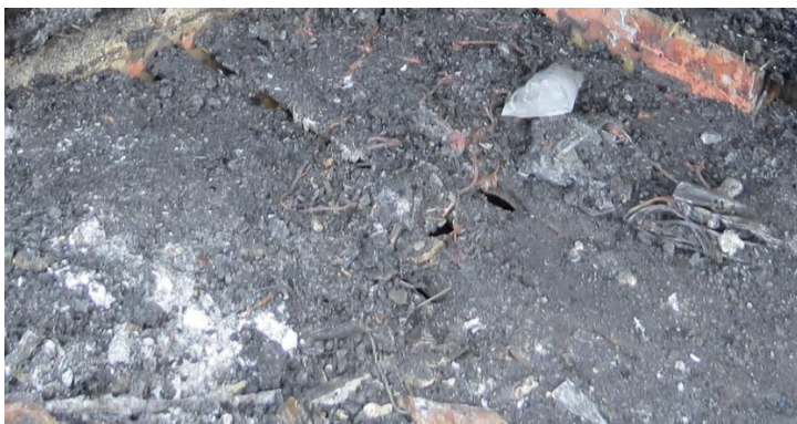
Bild 3: bilden visar Kabelrester och kraftiga brandskador med genombränningar på altangolvet
