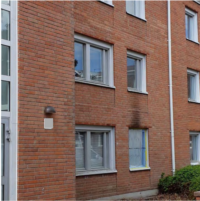
Bild 2. Fönster till brandlägenheten, där sovrumsfönstret försetts med träskiva, det syns även sot ovanför fönstret.
