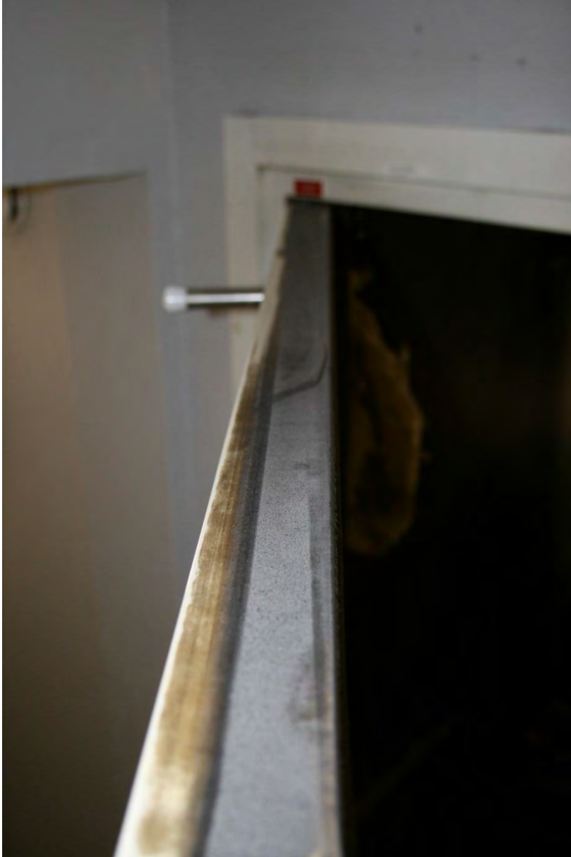
Bild 9. Sotbeläggning ovansida av dörrblad.
