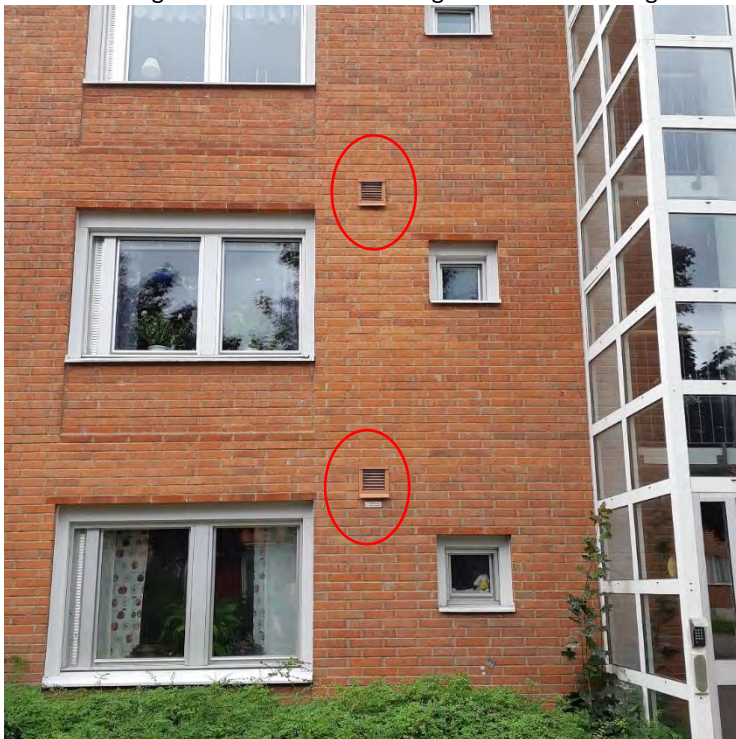
Bild 6. Uteluftsgaller till ventilation.
