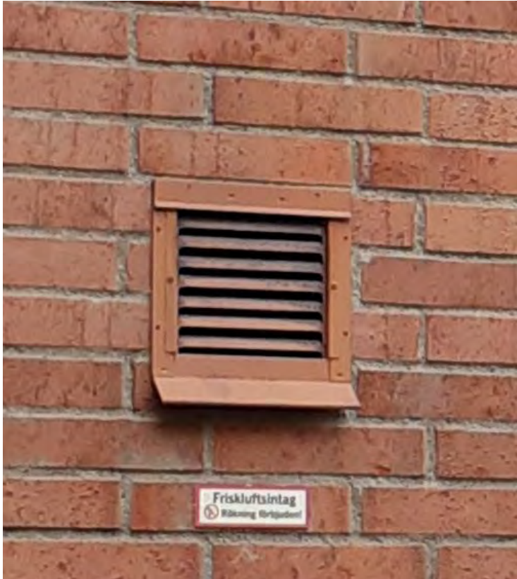
Bild 7. Uteluftsgaller till ventilation.
