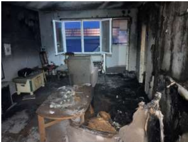
Vardagsrummet, vy mot balkong. Foto: Räddningstjänsten
