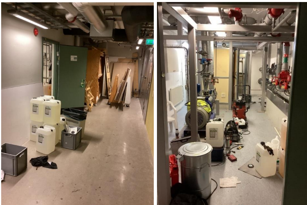
Figur 2. Bild till vänster - Dunkar med diesel vid insatsen. Bild till höger - Dunkar med diesel och övrig utrustning i sprinklercentralen vid insatsen.
