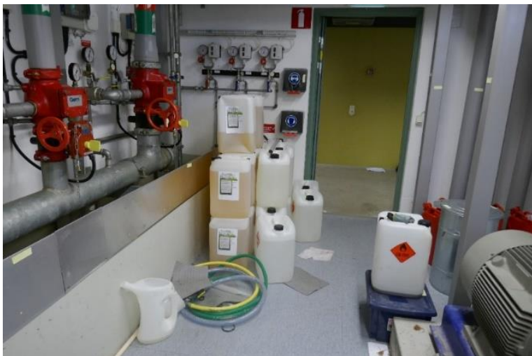
Figur 1. Dunkar med diesel i sprinklercentralen vid platsbesöket den 11 mars.
