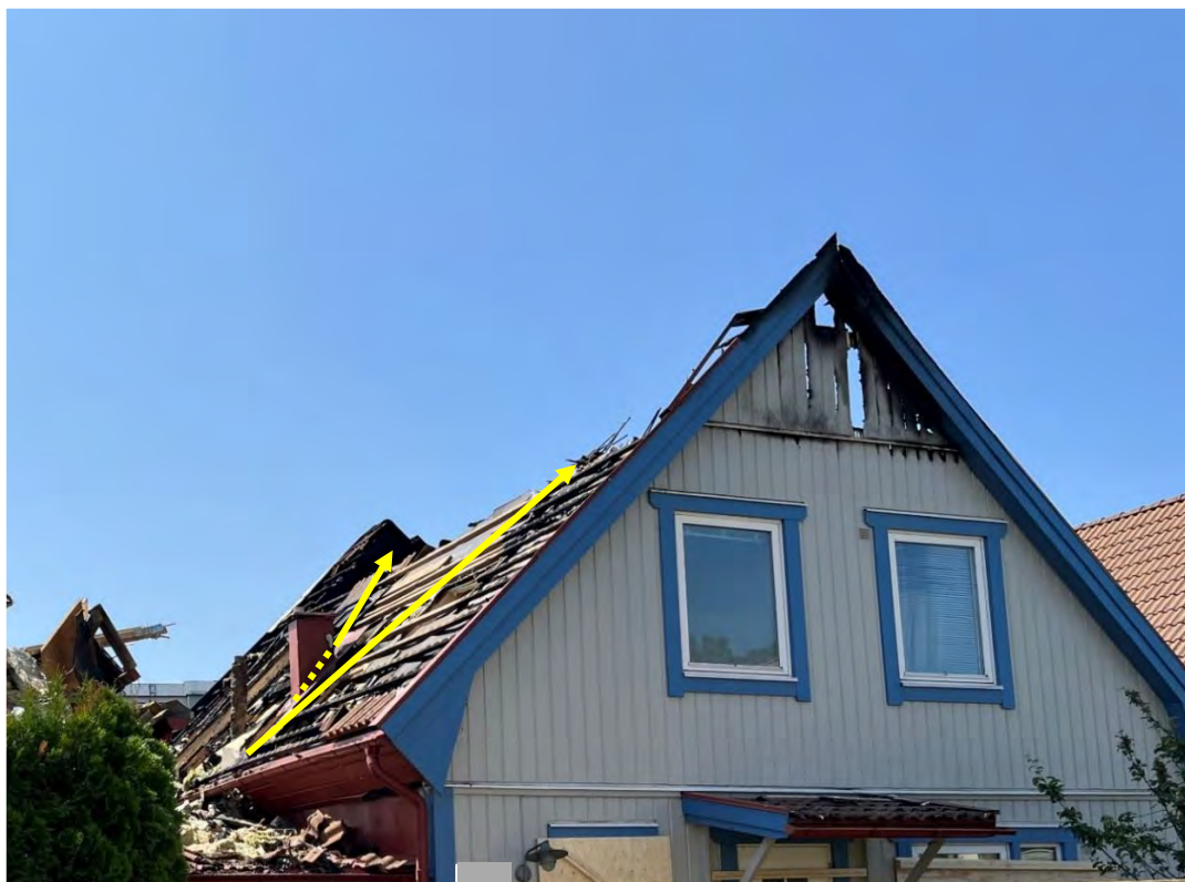
Figur 8. Tecken på brandspridning på hus 7 via kattvid, via luftspalt under tegelpannorna, till krypvind markerad. Foto taget av utredaren 2023-06-21.
