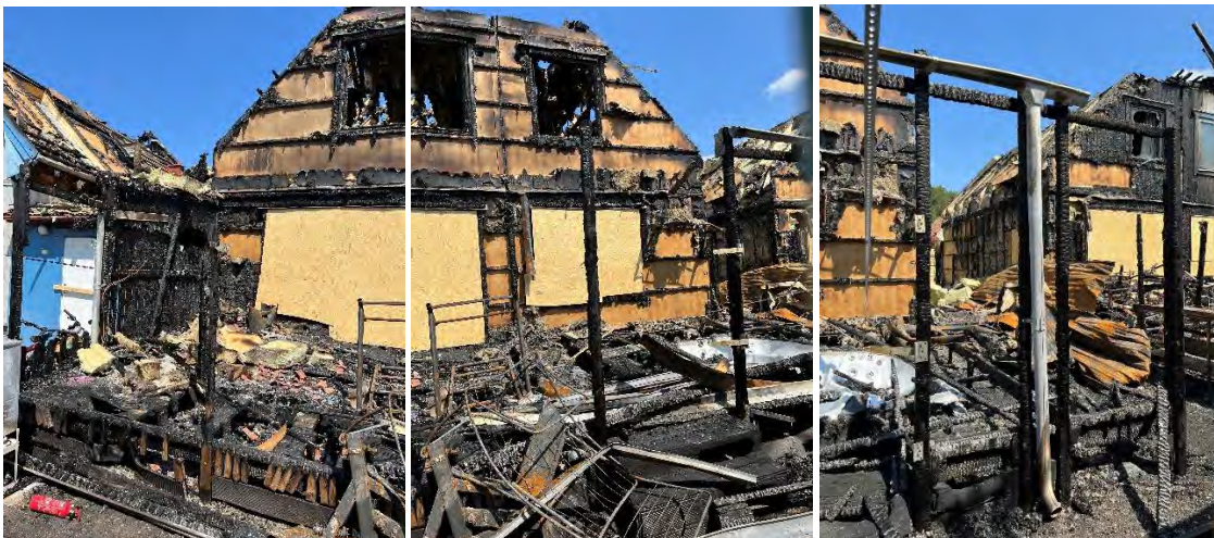
Figur 7. Skadeutbredningen på ■ 5:ans baksida. Foto taget av utredaren 2023-06-21.
