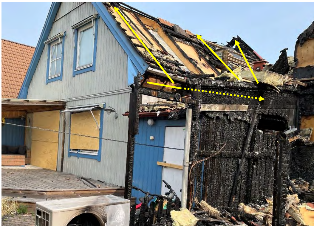
Figur 7. Tecken på brandspridning på hus 7 via kattvid samt via luftspalt under tegelpannorna, till krypvind markerad. Foto taget av utredaren 2023-06-21.
