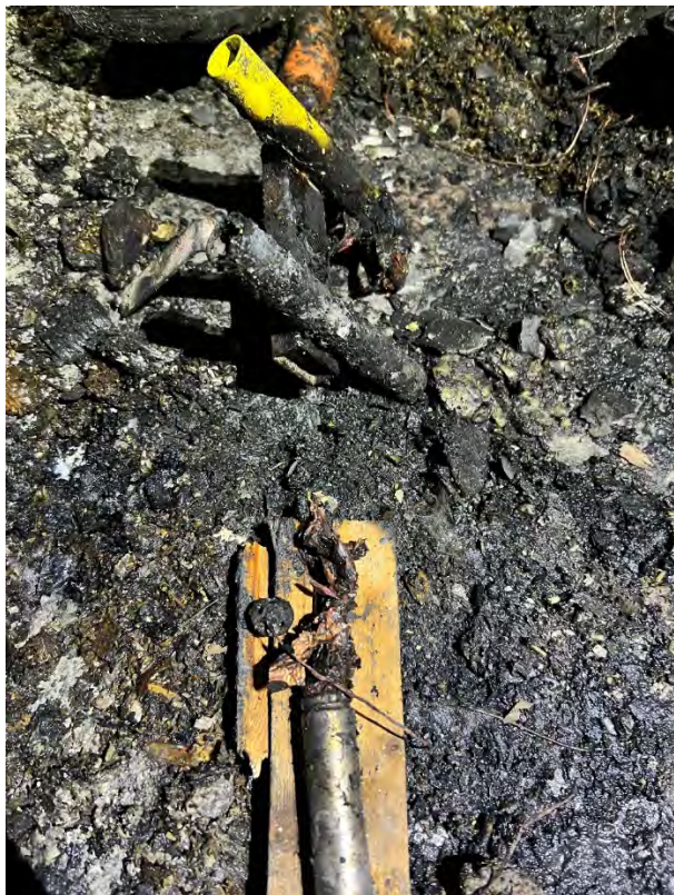
Rester av lampan och litium-Ion batteri.
