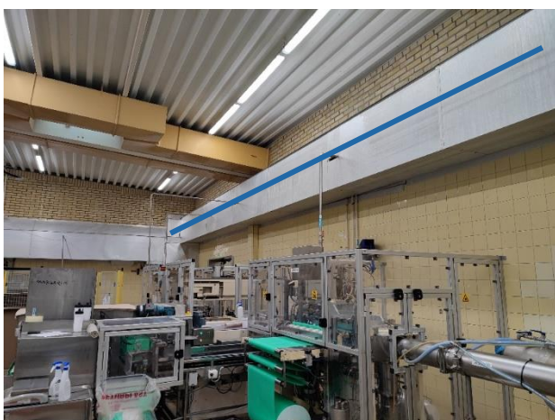
Figur 3 - Inbyggd rörledning för ammoniak (blå markering).
