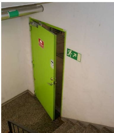
Figur 6. Dörr mellan källare och trapphus stängde inte ordentligt med hjälp av dörrstängaren.
