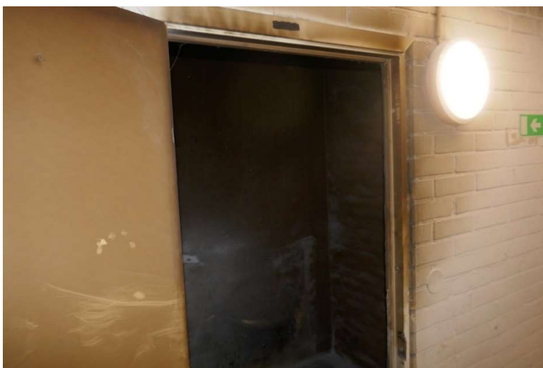
Figur 2. Brand- och sotskador i ett förrådsutrymme i källaren.
