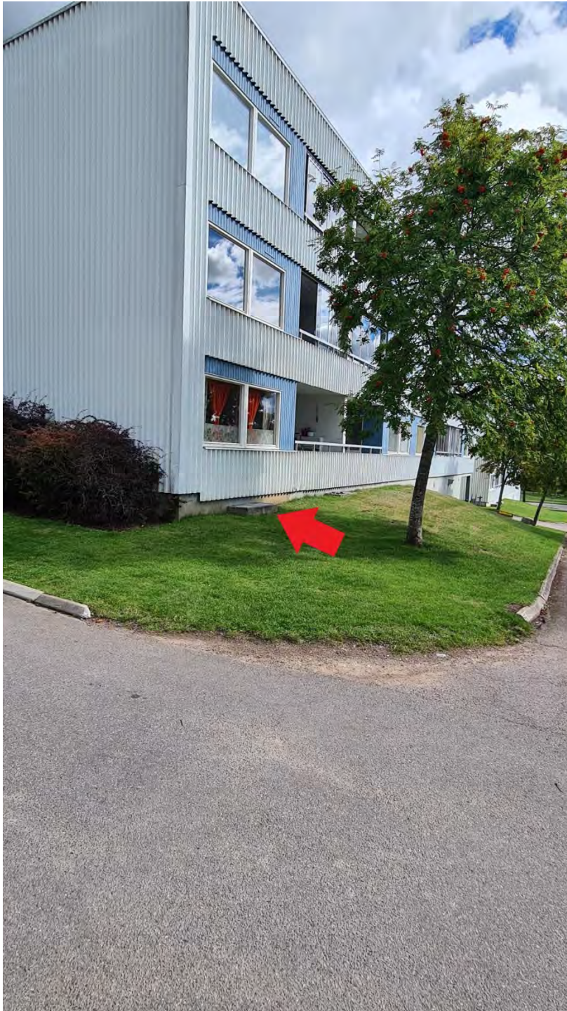
Bild 7: röd pil visar vart det varma fönstret låg. Detta fönster visade sig sedan leda direkt in till brandrummet.
