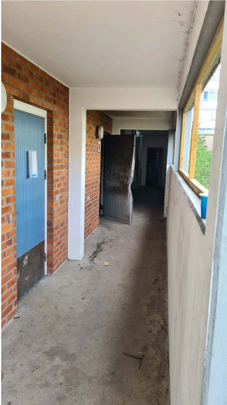
Bild 3: Angreppsväg/ baspunkt med bruten dörr.
