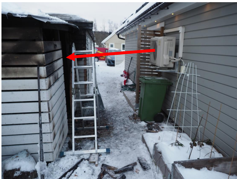
Bild 7 Visar värmepumpens placering i förhållande till vedförrådet och det primära brandområdet. Pumpen kan ha blåst luft rakt i riktningen mot branden.
