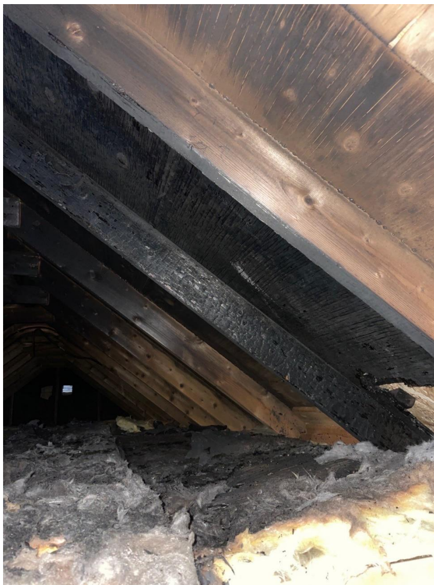
Bild 4 Visar utrymme i kallvinden längst upp i huset. Mest tydliga brandskador mellan två av takstolarna. Dessa är placerade i linje med det primära brandområdet.
