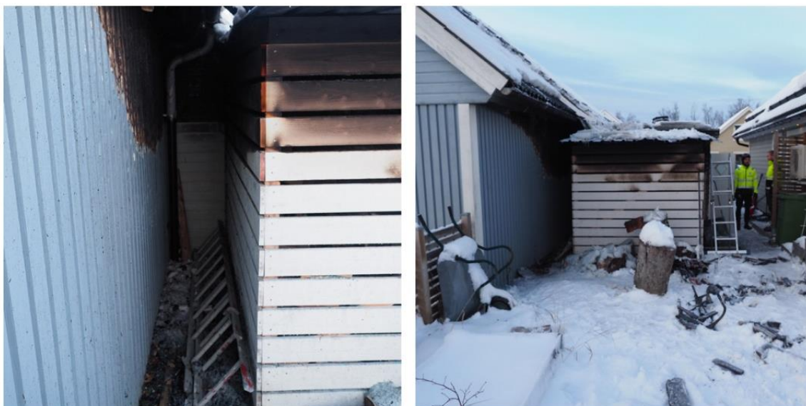
Bild 3 Visar vedförrådets utformning och närhet till grannens hus. Brandskador på husfasaden som tyder på att spridning skett från vedförrådet.
