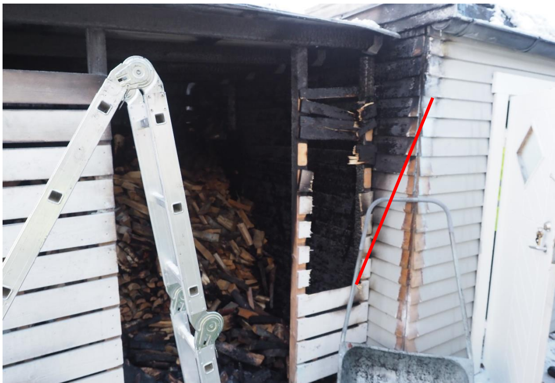
Bild 5 Visar utsidan på vedförrådet. Primärt brandområde bedöms vara innanför den lilla träväggen. Brandmönster utgår nedifrån och inifrån.
