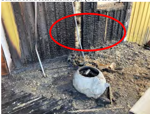
Bild 2: Röda cirkeln visar primära brandstartsområdet med kraftigt brända fasadbrädor.
