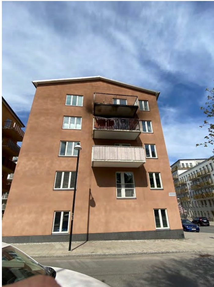
Bild 1. Brand på balkong på våning tre. Foto: Fredrik Lindström
