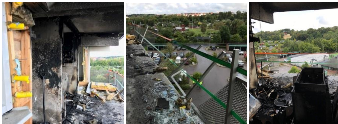
Figur 7,8 och 9 Branddrabbad lägenhet, Inträngning via loftgången, Figur längst till höger visar en bild inifrån lägenhet och ut i det fria.
