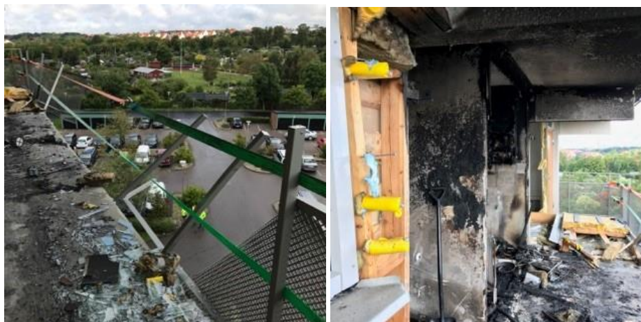
Figur 11, och 12, Loftgången med räcket som träffades av den utflygande väggen till lägenheten i samband med explosionen.
