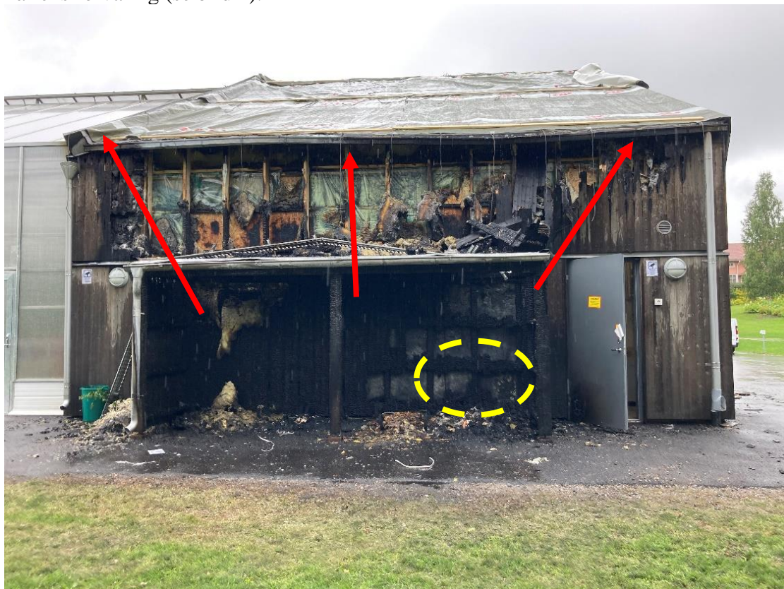
Bild 2: Gula cirkeln visar primära brandstartsområdet. Röda pilarna visar den väg branden spridit sig upp under takfoten.
