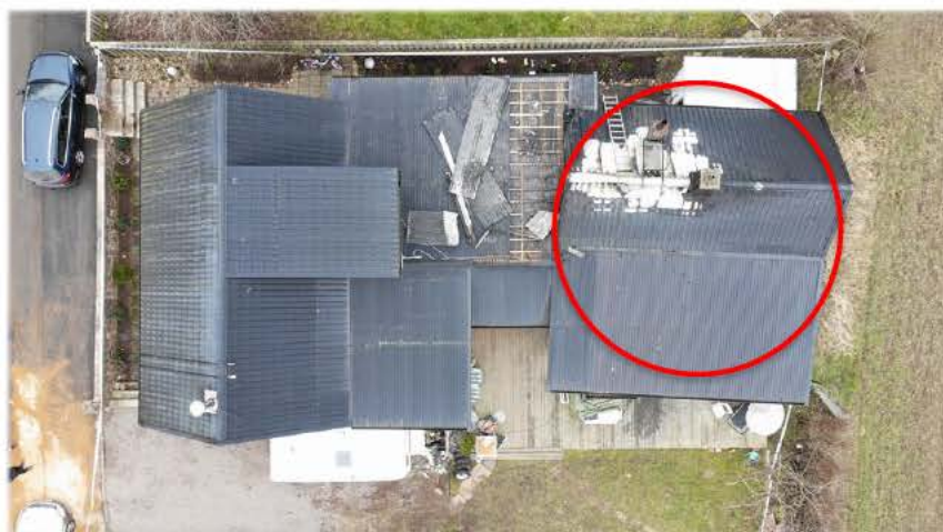
Figur 2, Annexet markerat med röd ring,. Värmeskador syns på taket intill skorstenen.
