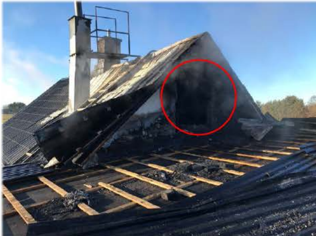
Figur 10, Ovandelen på annexet var övertänd med lågor ut genom öppningen (röd ring).
