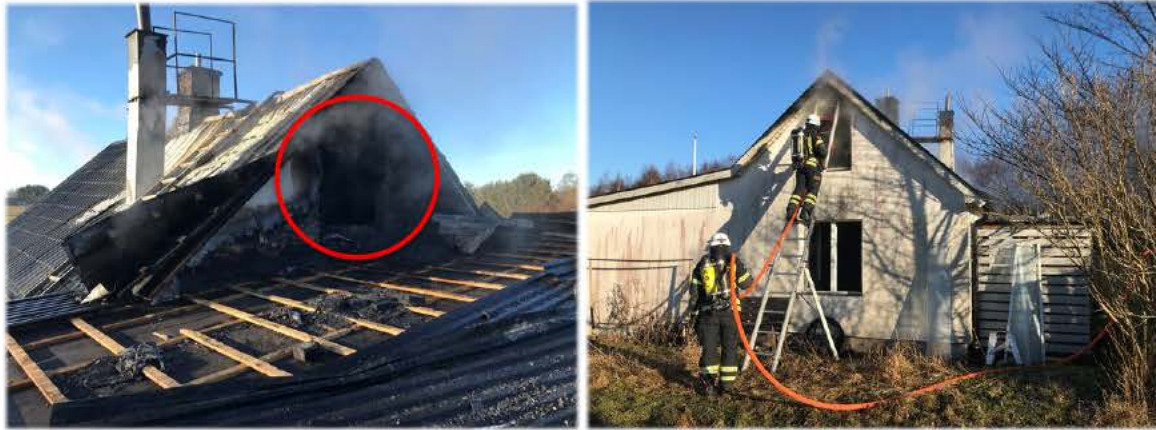
Figur 13, 14, Fönstret där slutna stråle dämpade branden, gaveln där eftersläckning skedde.
