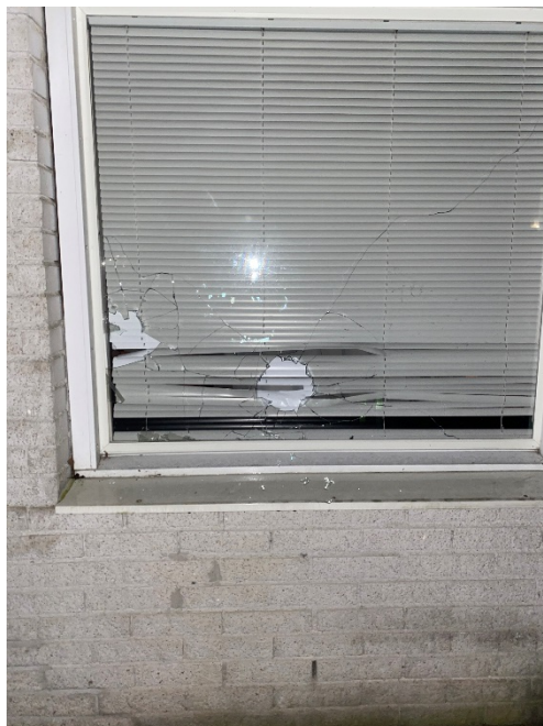
Figur 2. Hål i fönster, fotat utifrån altanen.
