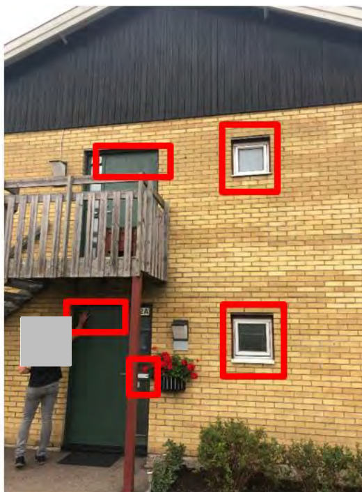
Bild 5. Vintergatan 2 (nr: 7 i bild 1). Skador markerade med röd fyrkant är: Spruckna fönster, färgskada på dörrar samt nedsmält dörrklocka.
