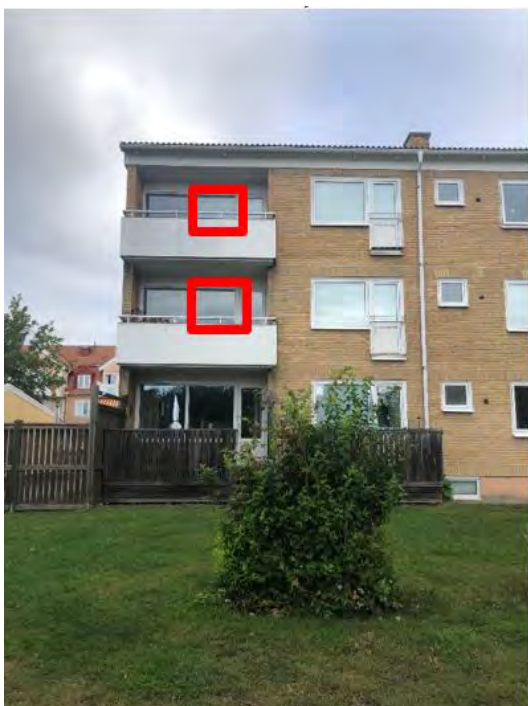
Bild 4. Storgatan 16 (nr: 4 i bild 1). Spruckna fönster markerade med röd fyrkant. Färg på lister på fönster och dörrar på balkongerna har blivit missfärgade och bubblat upp.
