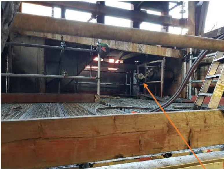
Ett av två Utloppsrör med Sprängbleck varvid det brann ur.
