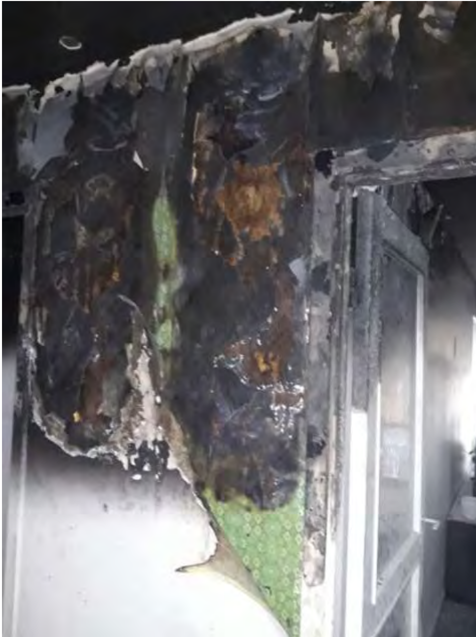
Figur 12: Foto på väggen i hallen med dörr till vardagsrummet till höger. Notera att glaset i dörren är helt. Flera lager tapet som brunnit är också synligt, vilket gett mer fäste för branden.
