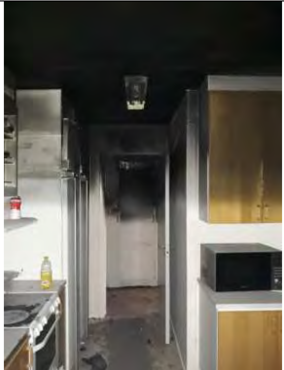
Figur 10: Foto på köket sett mot hallen. Kraftig sotning närmast dörren men saltkar (plast) och flaska med matolja (plast) är opåverkade av värme.
