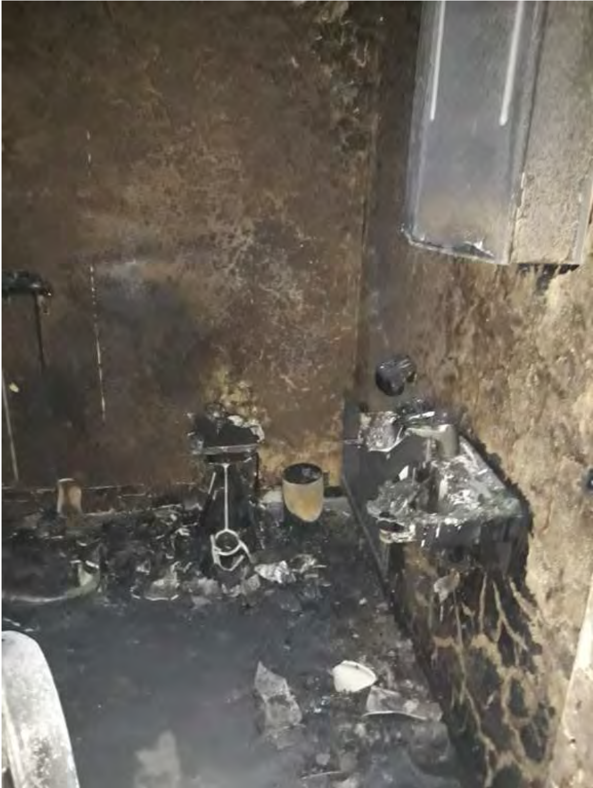
Figur 8: Foto på badrummet med den totalförstörda toalettstolen i fotots mitt. Till vänster skyntas en tvättmaskin. Ungefär hälften av tvättstället i porslin återstår, övrigt är krossat.
