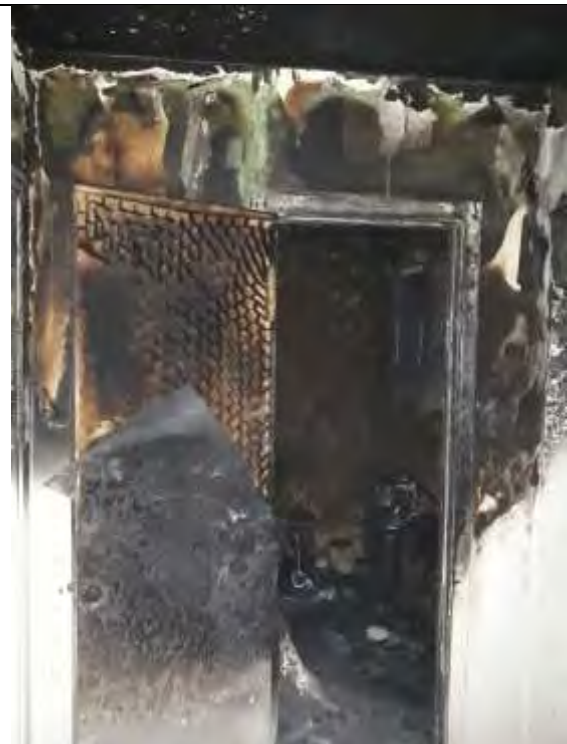
Figur 7: Foto på badrummet, sett från hallen med lägenhetens dörr mot trapphuset bakom kameran. Ett brand-V syns tydligt samt att brandskadorna på dörrens insida är mycket kraftigare på den övre halvan.
