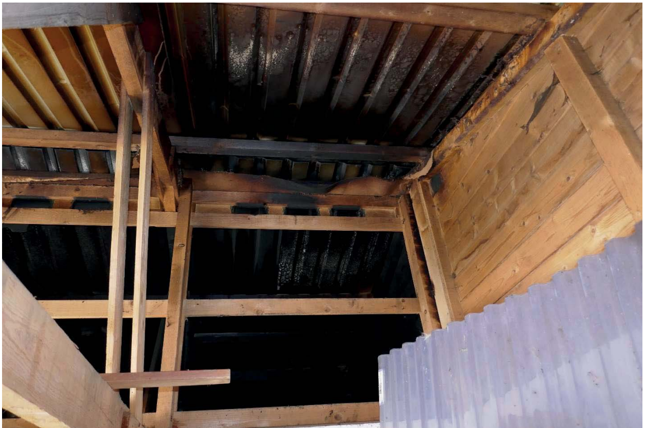
Foto 3. Brandskador upp på vinden.
