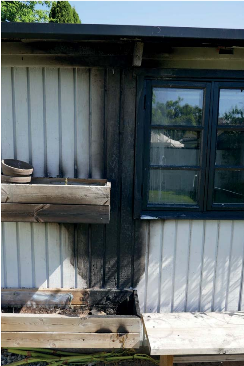
Foto 1. Brand i blomlådan och upp på fasaden.
