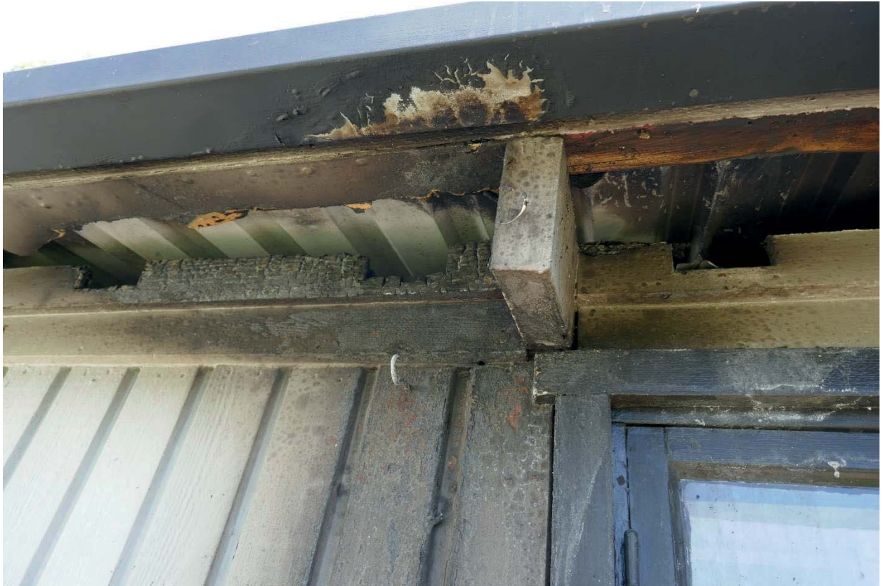
Foto 2. Branden spreds från fasadbrädorna och genom den luftade takfoten till vinden.
