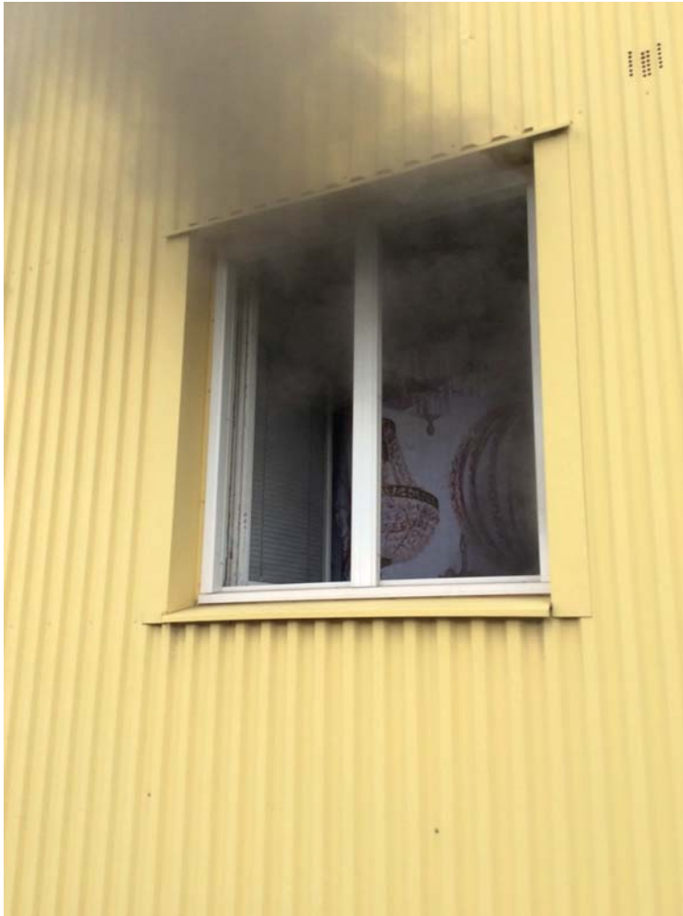
Foto 1. Vid räddningstjänstens framkomst kom det ut rök ifrån sovrummets fönster.
