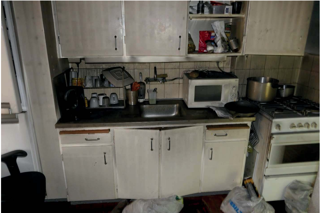
Foto 3. Rök och sotskador i köket.
