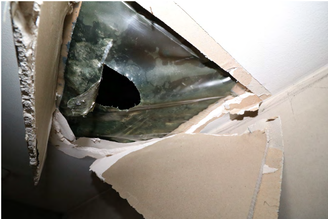
4Visar takets uppbyggnad med 13 mm gips och plast. Här är isoleringen bortplockad över plast
