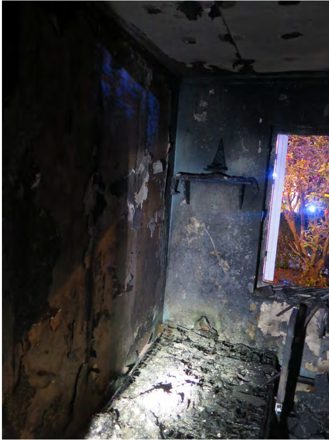
Foto 1. Brandskador i sovrummet på bottenvåningen.
