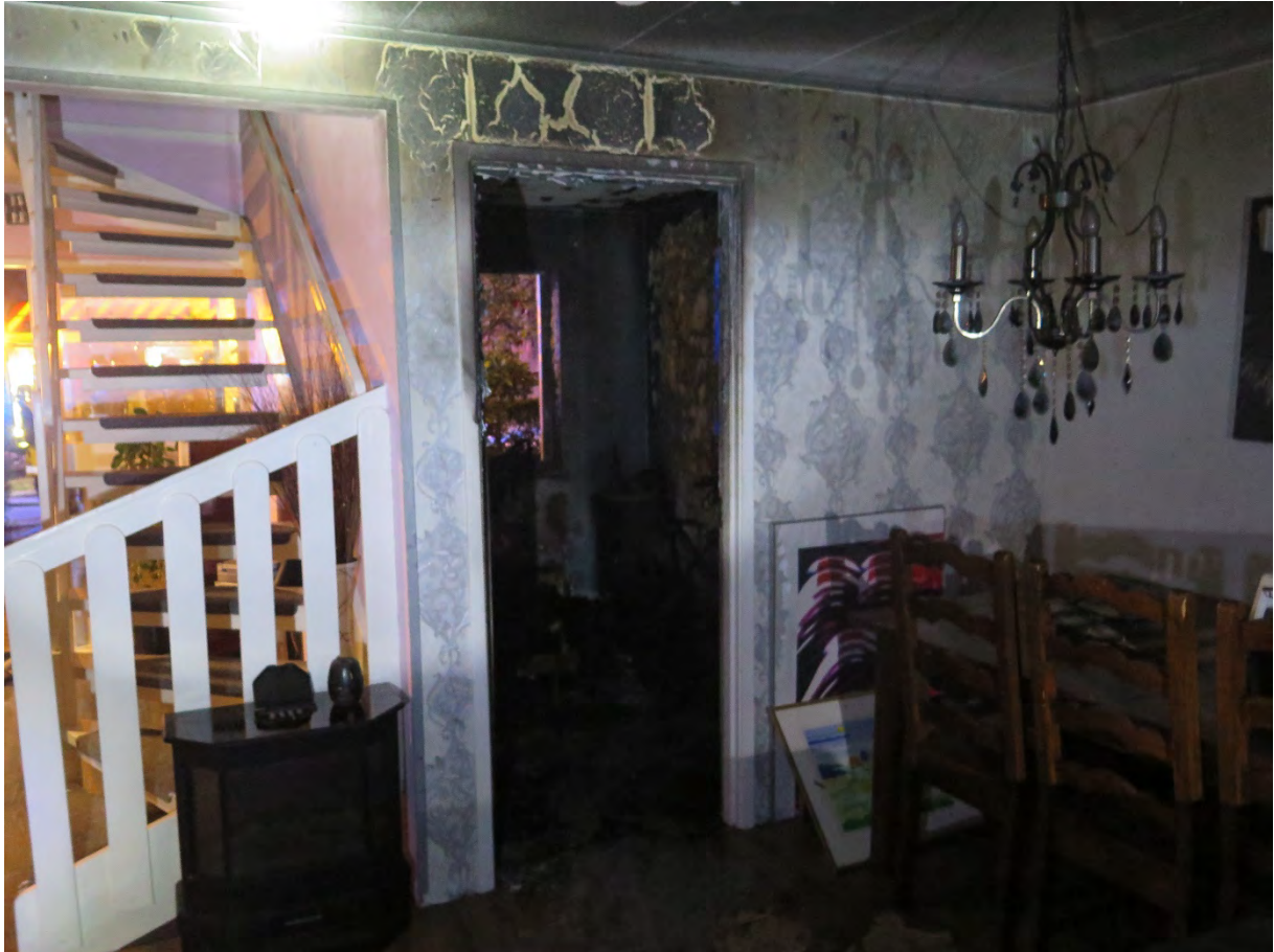
Foto 3. Sotskador på väggar och tak utanför det drabbade sovrummet.
